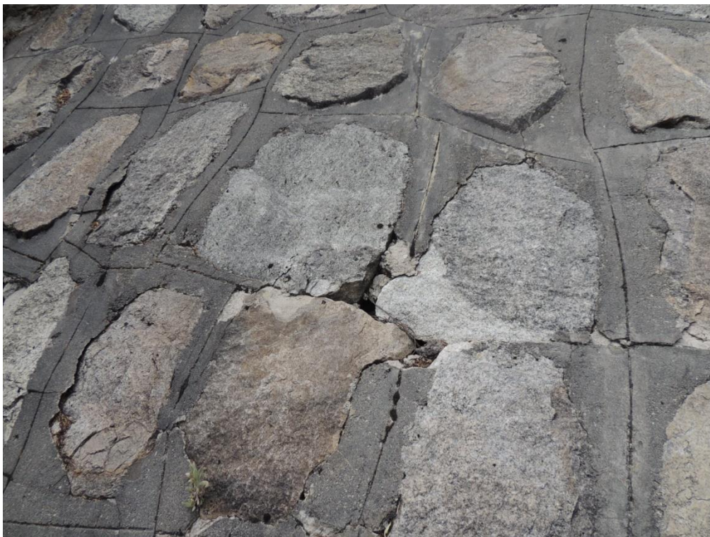
Fotografía N° 05: Vista de las rajaduras del dique
