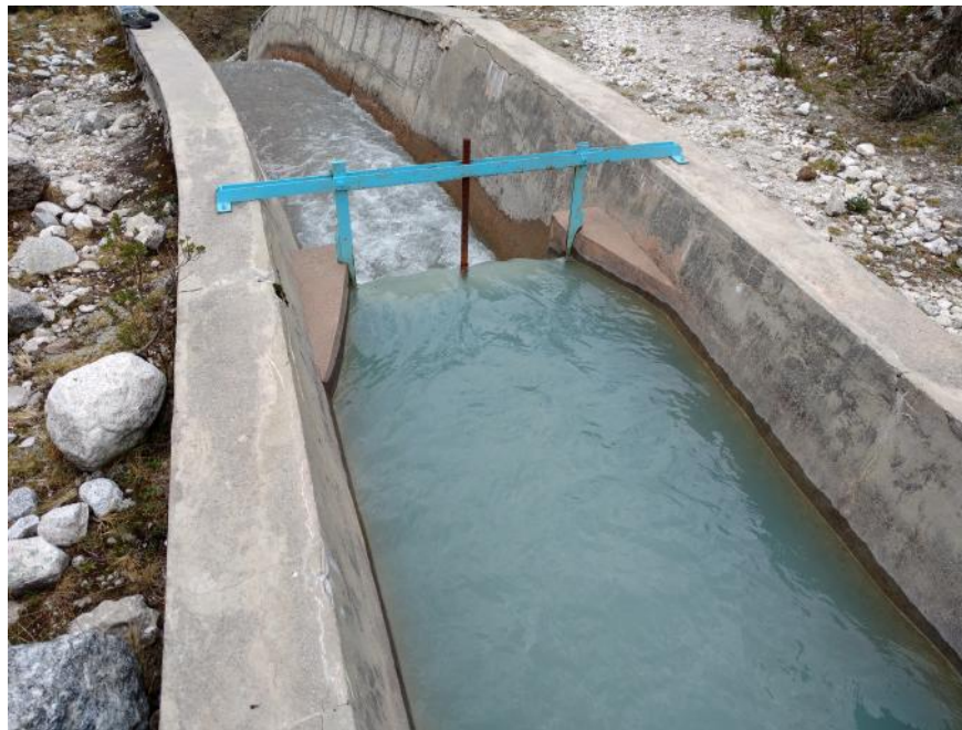
Fotografía N° 12: Vertedero de pared delgada (canal de salida).
