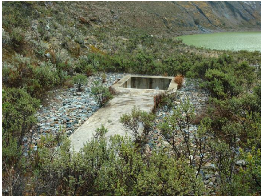
Fotografía N° 10: Vista de la cámara de captación – Aliviadero.
