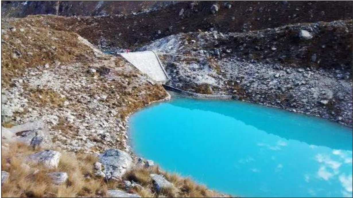
Figura 27. Dique de tierra revestido, conducto y canal de salida de la laguna Yuracocha, Huaylas, Ancash.
