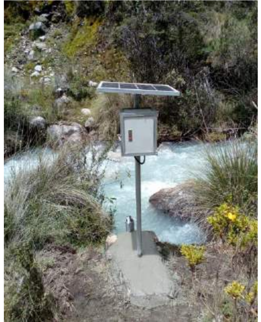
Figura 50. Limnógrafo instalado en la subcuenca Llaca.
