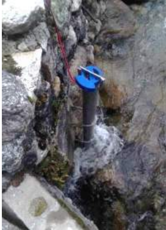
Figura 47. Limnógrafo instalado en la quebrada Cojup.
