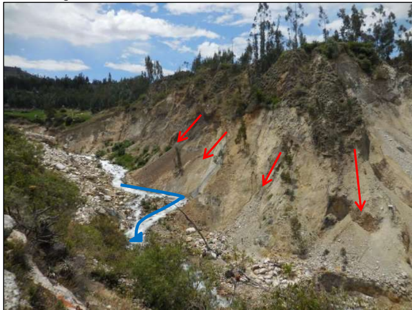
Fotografía N° 67: Derrumbes locales de material cuaternario.
