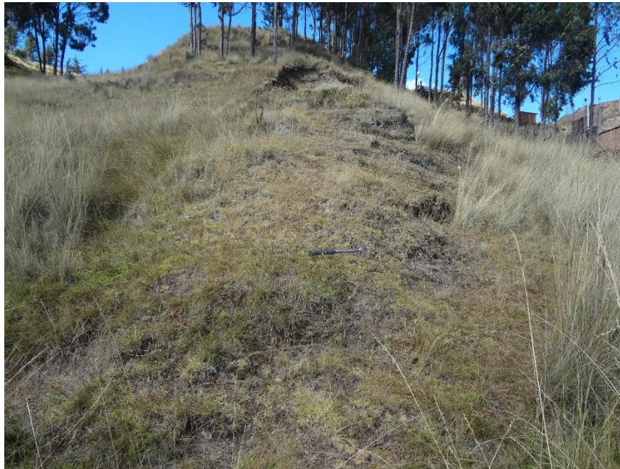
Fotografía 13.- Activación de pequeños deslizamientos en la ZRECU06.
