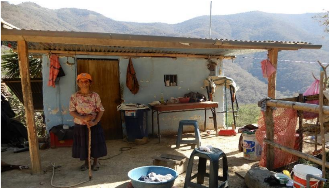
Fotografía 4. En este sector el deslizamiento en el año 1998, destruyó la vivienda de la señora Anita Saavedra Chinchay de Valle; actualmente se observa la construcción de una nueva vivienda, con material rústico (carrizo y barro), por temor a la recurrencia del evento, ubicada en las coordenadas UTM WGS 84: norte 9485772 y este: 627383.
