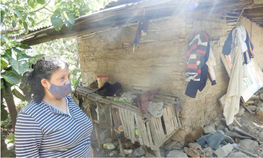
Fotografía 5. En este sector el deslizamiento destruyó la vivienda de la señora Rosa Gladis Córdova Ríos; se observa la construcción de una nueva vivienda, con material rústico (carrizo y barro), por temor a la recurrencia del evento, se encuentra ubicada en las coordenadas UTM WGS 84: norte 9485801 y este: 627386.
