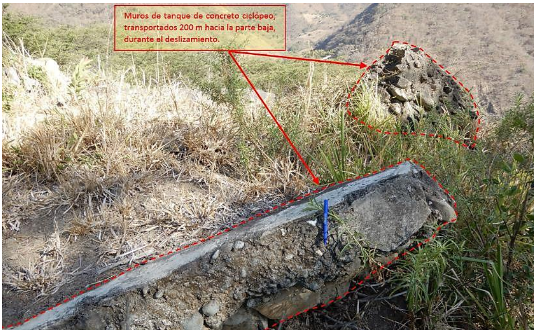
Figura 8. Resto de tanque de agua construido con concreto ciclópeo, arrastrado 200 m hacia la parte baja durante el deslizamiento.
