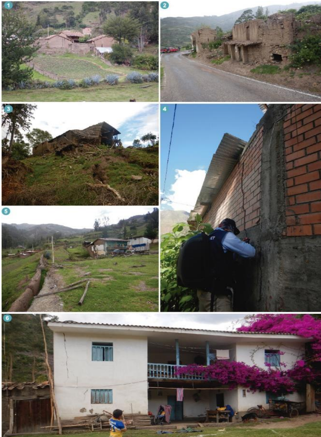
Figura 31. En las figuras 1), 4), 5) y 6) se aprecian los muros (adobe y ladrillo) de las viviendas agrietadas. Figura 2) y 3), se observan viviendas destruidas.
