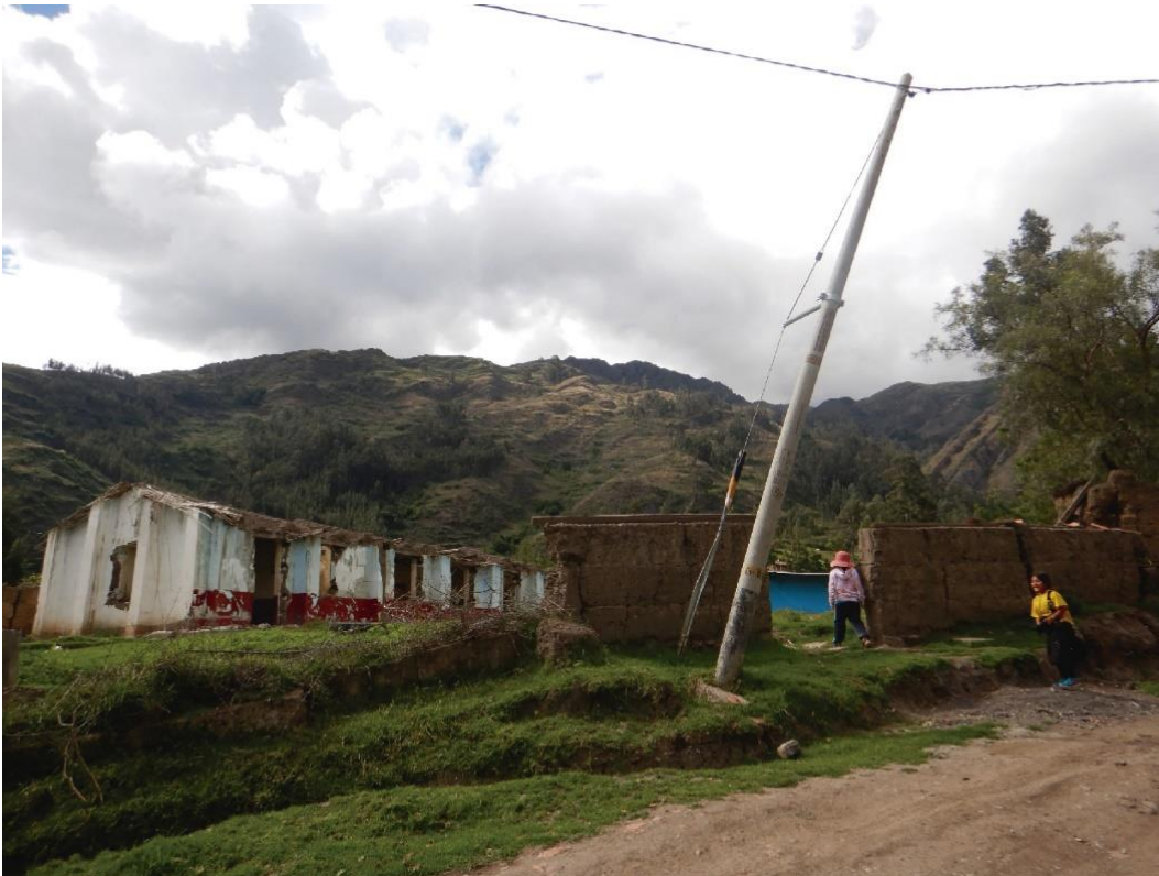
Fotografía 1. Se observa la institución educativa inicial del centro poblado Mallas abandonado por el constante y severo daño que sufrían sus muros, así mismo se puede observar postes de energía eléctrica inclinados \sim 15^\circ en las coordenadas UTM 8959818 N, 259360 E, con una altitud de 3153 m s.n.m
