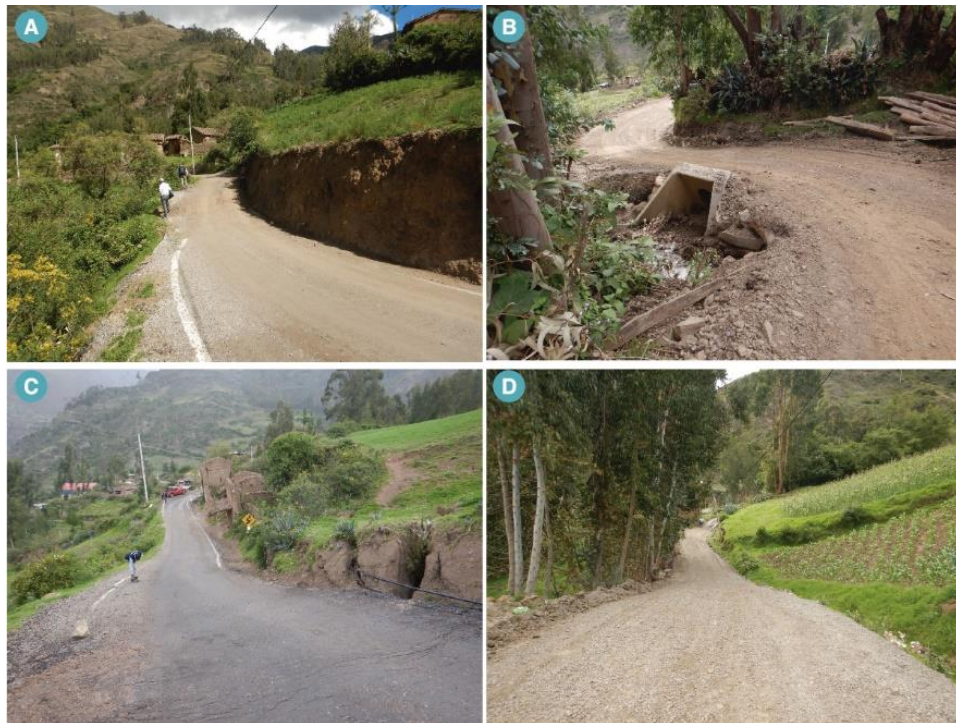
Figura 33. Se observa: A) Asentamiento 80 m de tramo de carretera en el poblado Mallas (8960117 N, 259359 E, altitud 3193 m s.n.m), B) Alcantarilla de concreto afectado (8959384 N, 259188 E, altitud 3075 m s.n.m) y D) 140 m, de tramo asentado (8959435 N, 259260 E, altitud 3076 m s.n.m).
