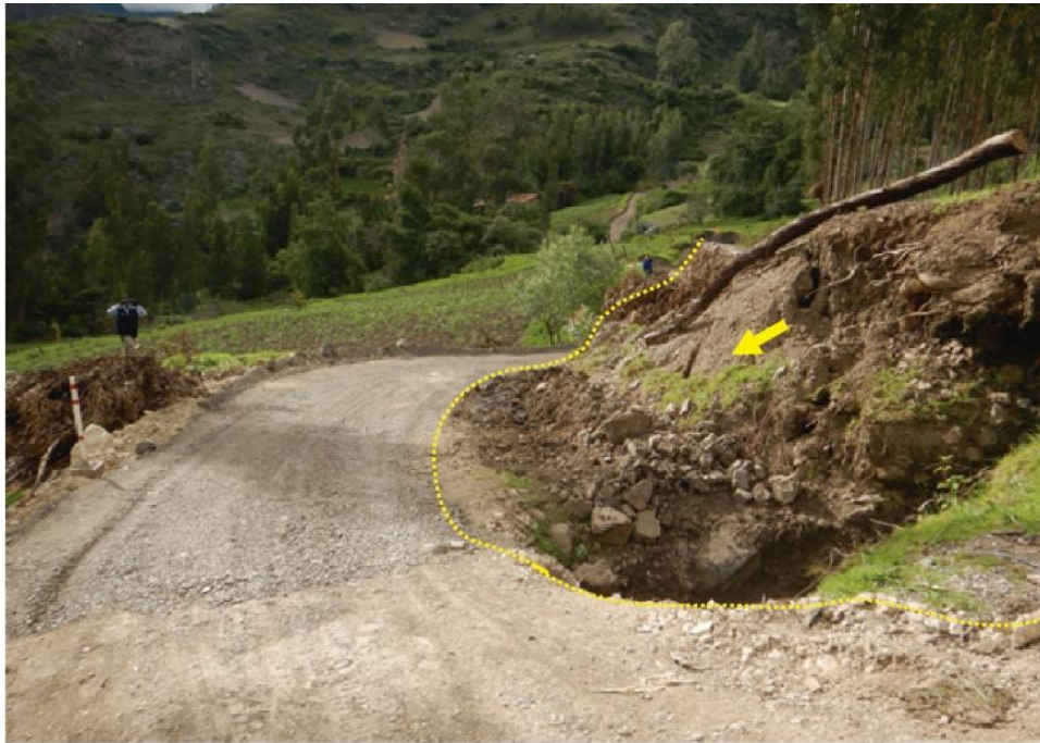
Figura 32. Se observa asentamiento de un tramo de 80 m. entre Mallas y Colpa, ubicada en las coordenadas UTM 8959435 N, 259260 E con una altitud de 3057 m s.n.m.
