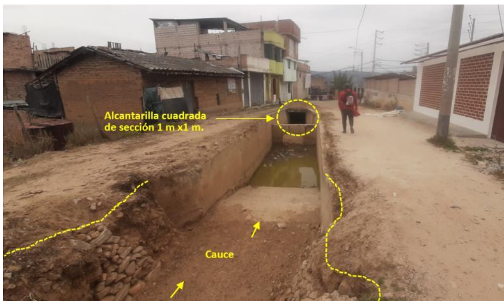
Figura 23. Obra de encauzamiento deficiente en la quebrada Arcomayo. Advértase, que la sección de la alcantarilla es muy pequeña en comparación al ancho del cauce de la quebrada, incrementando el peligro de desbordes de las zonas adyacentes (775149 E / 9205920 N).
