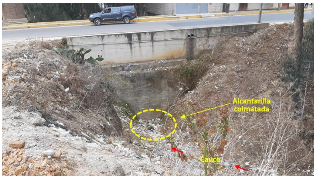
Figura 25. Vista del cruce de la quebrada Calispuquio con la Av. Independencia. Advértase que la alcantarilla se encuentra completamente colmatada por el arrojado indiscriminado de residuos sólidos.
