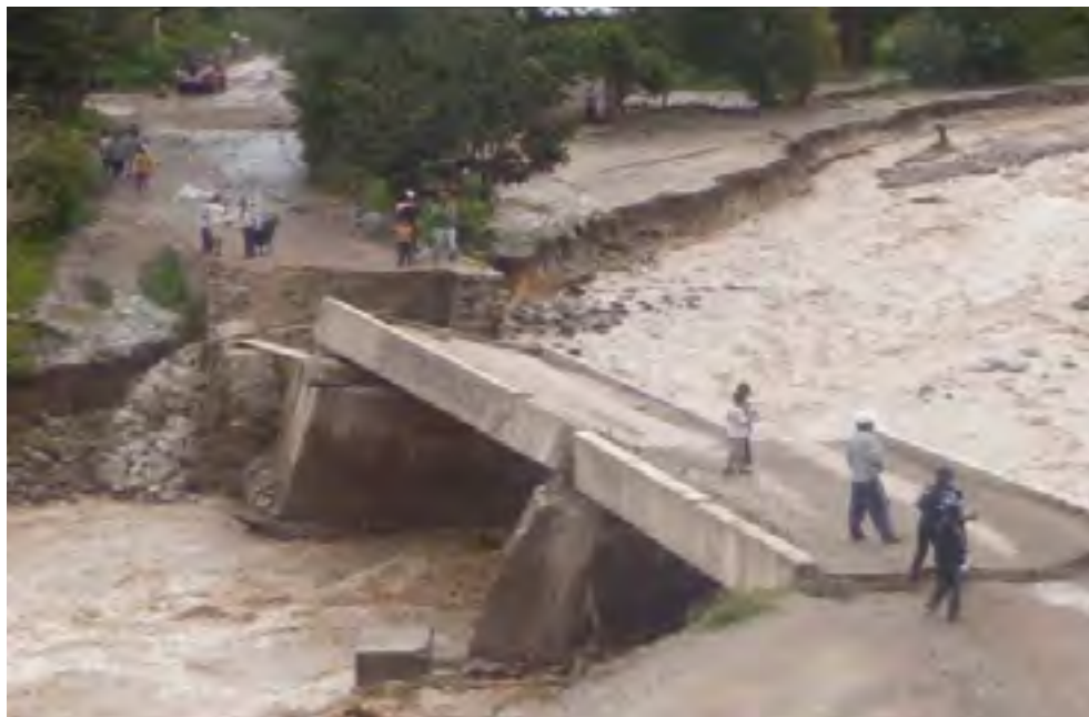
Puente Muyurina colapsado
