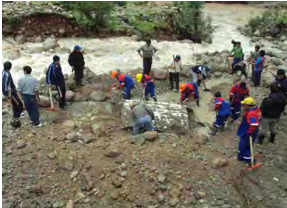
Intensas lluvias afectan a los pobladores de la localidad de Acoria, distrito de Acoria, provincia de Huancavelica, febrero 2011.
