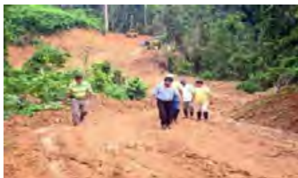
Deslizamientos por intensas lluvias en la Comunidad nativa Wawico, distrito de Imaza, provincia de Bagua, febrero 2011
