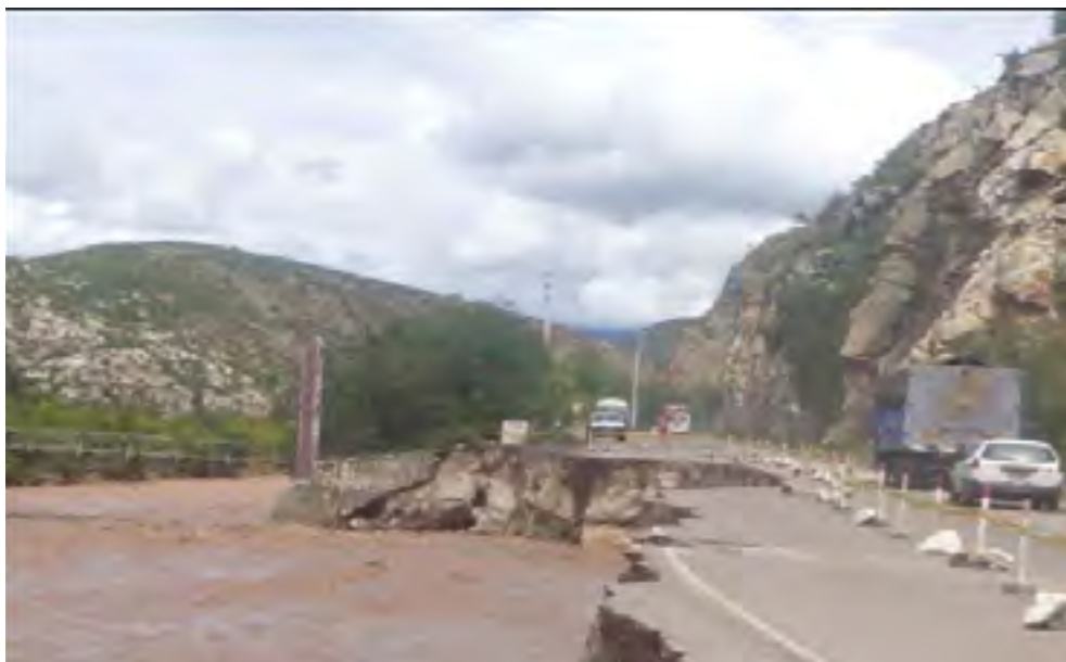
Pérdida de carretera Huamanga - Huanta por erosión de la crecida de río
