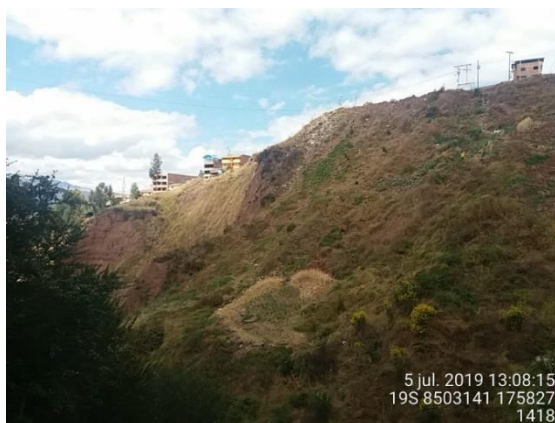
Fotografía 3: Material de relleno reciente con suelos coluviales recientes ubicados en la base del talud Margen izquierda PPJJ Independencia. Fuente: Equipo Técnico SGOT/PM41ZRE
