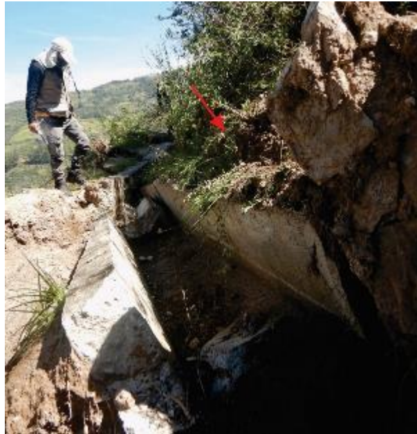
Figura 15. Vista de un canal de regadío de concreto destruido, que se encuentra en la parte alta de la carretera del T-1, ubicado en las coordenadas UTM 8980213 N, 205732, con una altitud de 2837 m s.n.m.
