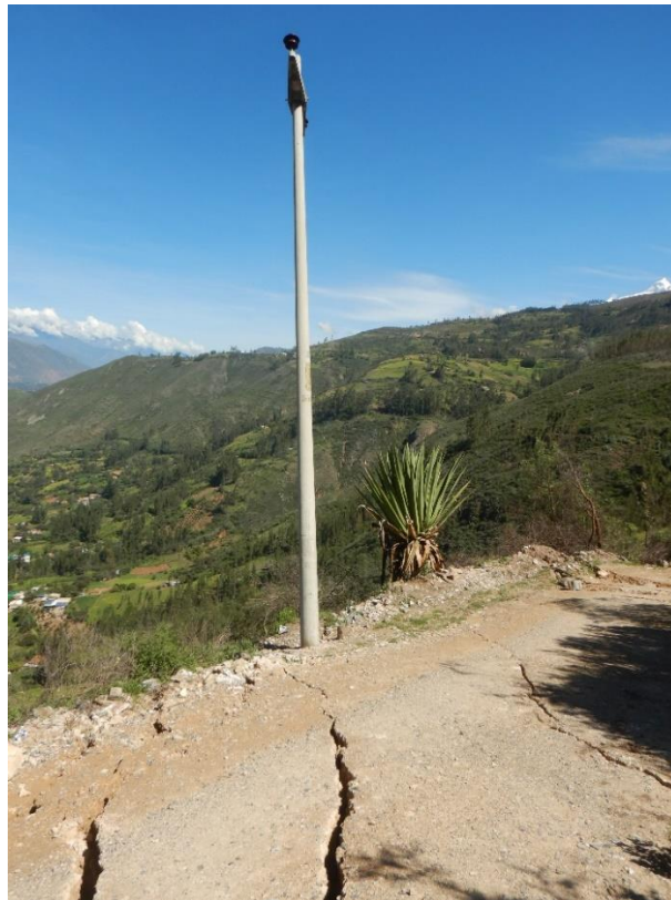
Fotografía 2. Se observa grietas transversales de 10 a 30 cm, una de estas con dirección al poste de concreto de tendido eléctrico, el que se encuentra inclinado hacia la ladera. Ubicado entre las coordenadas UTM 8980257 N, 205706 E, con una altitud de 2825 m s.n.m.
