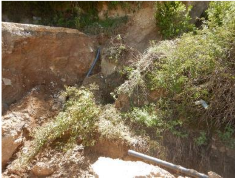
Figura 17. Se observa la tubería del agua potable rota, dejando sin abastecimiento al sector de Shancayan.
