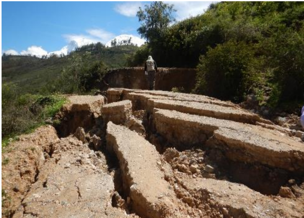
Fotografía 4. Condiciones del tramo de la carretera T1, afectado por el deslizamiento, la vía se encuentra destruida.
