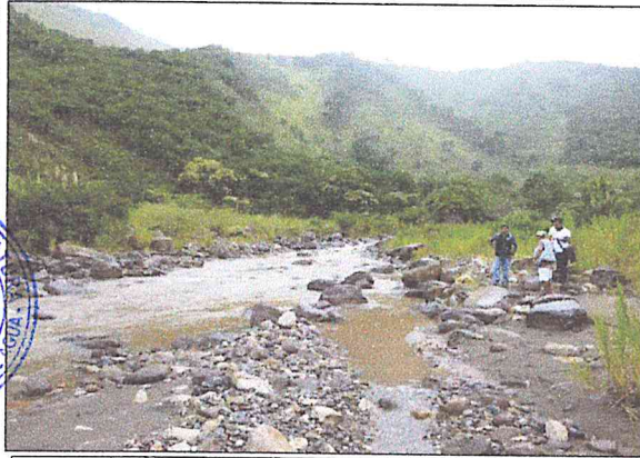
Erosión de riberas y colmatación de cauce de la quebrada Tataque en el canal Pacheco.
