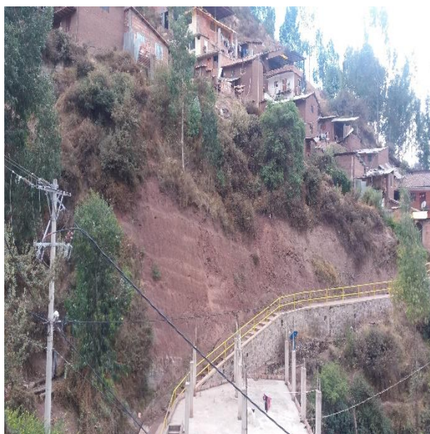
Fotografía 9: Pendiente escarpada en ladera de quebrada producto de corte de talud.
