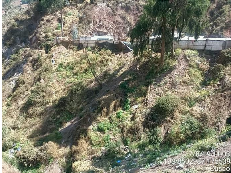
Fotografía 6: Material de Relleno en el lote adyacente a la Vía Cusco- Abancay. Fuente: Equipo Técnico PM41ZRE
