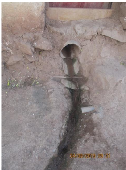
Fotografía 1: Eliminación de aguas servidas hacia la calle en la ZRECU11 en la APV Apurímac Fuente: Equipo Técnico PM41ZRE
