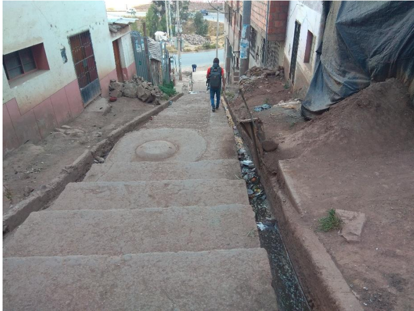
Fotografía 3: Acumulación de residuos sólidos en canal de evacuación de aguas pluviales Fuente: Equipo Técnico PM41ZRE
