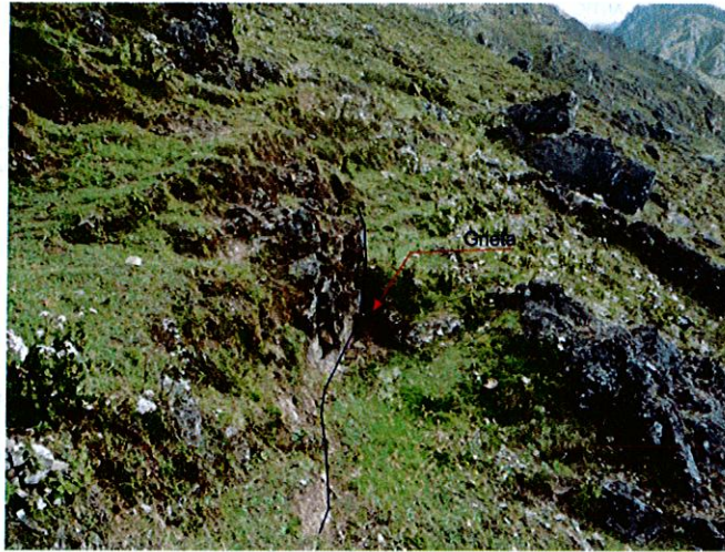
Foto 17: Grieta localizada sobre la corona del deslizamiento principal, con abertura de 0,10 m.
