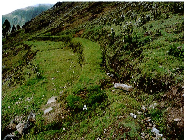
Foto 9. Canal de regadío sin revestimiento localizado por encima de la zona deslizamiento, en la imagen se puede observar que el agua sale del canal (A) y humedece el terreno.
