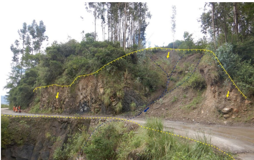
Figura 08: Muestra la zona de derrumbes en el punto 1 de evaluación, afectó 47 metros de carretera que conecta los poblados de Piscobamba y Vilcabamba.
