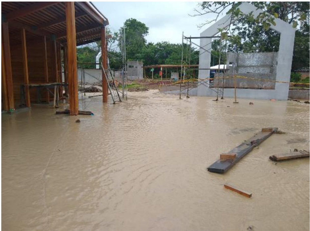
Figura 11. Inundación de la obra en construcción del “Proyecto de Acondicionamiento Turístico en la Laguna de Sauce”.
