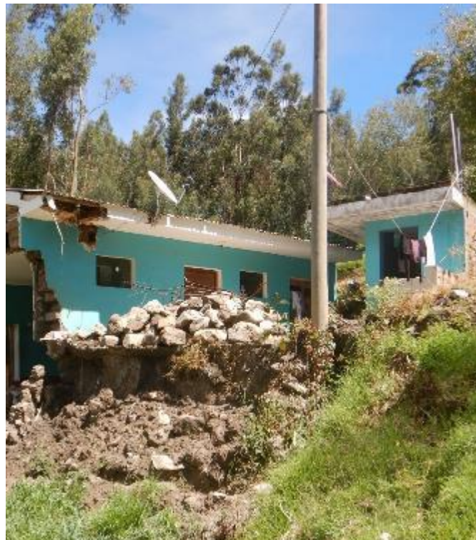
Fotografía 4. Poste de tendido eléctrico, que podría caer, ya que la base se encuentra expuesta, por la remoción de material que generó el deslizamiento.
