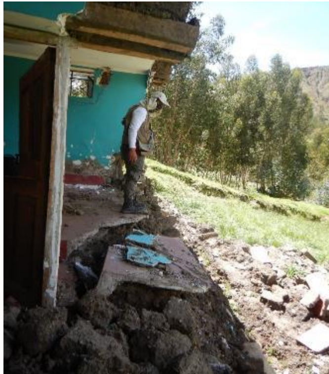
Fotografía 3. Se observa parte de la vivienda destruida por el deslizamiento, el suelo de la base de dicha vivienda presenta humedad.
