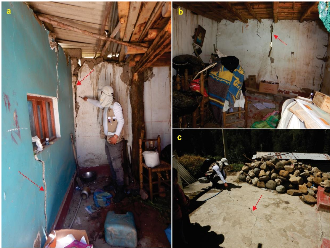
Figura 17. Se identificaron grietas longitudinales en las paredes de adobe internas de la vivienda, con aberturas de 0.5 cm al 10 cm, con profundidades del ancho del adobe; así como en el patio de concreto.
