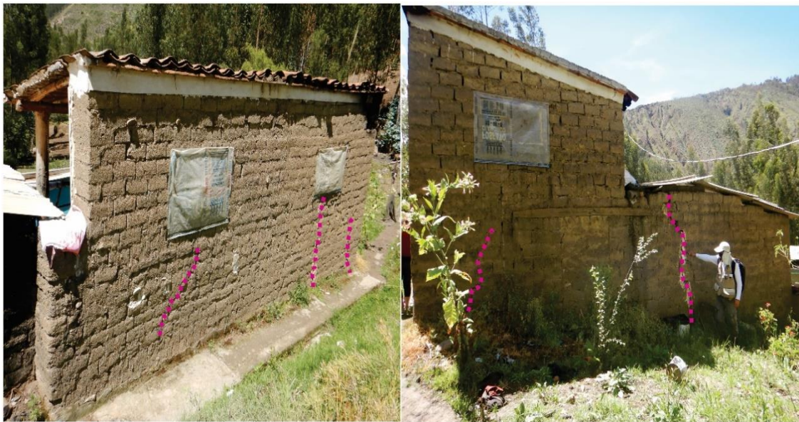
Figura 18. En las imágenes es posible observar los agrietamientos en paredes de adobe de viviendas en el sector Huantay del centro poblado de Hualcán; así como el empuje de la pared de adobe.
