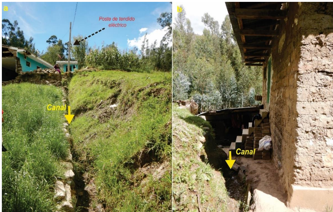
Figura 21. Se observa canal por donde discurre el agua del regadío que pasa a menos de 0.50 cm de ambas viviendas afectadas.
