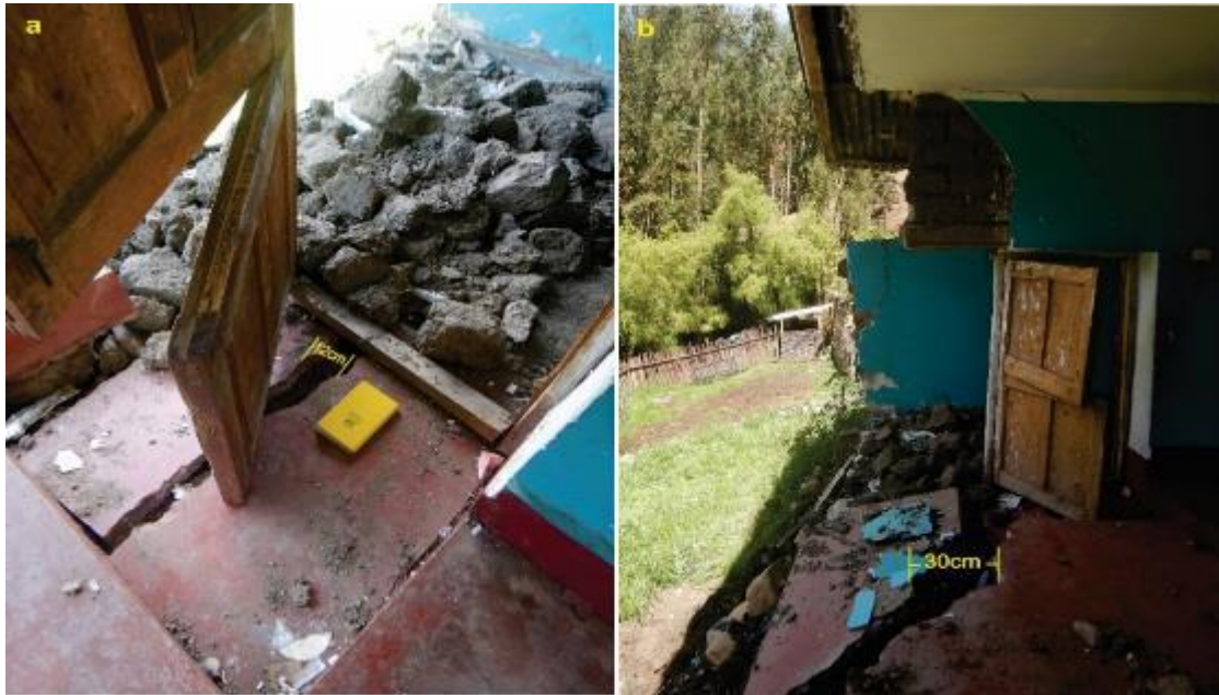
Figura 16. Vista donde se observa grietas transversales en el piso de la vivienda, con medidas de 0.10 a 0.30 cm, con profundidades de hasta 0.50 cm, así como las puertas de madera que quedaron inservibles.
