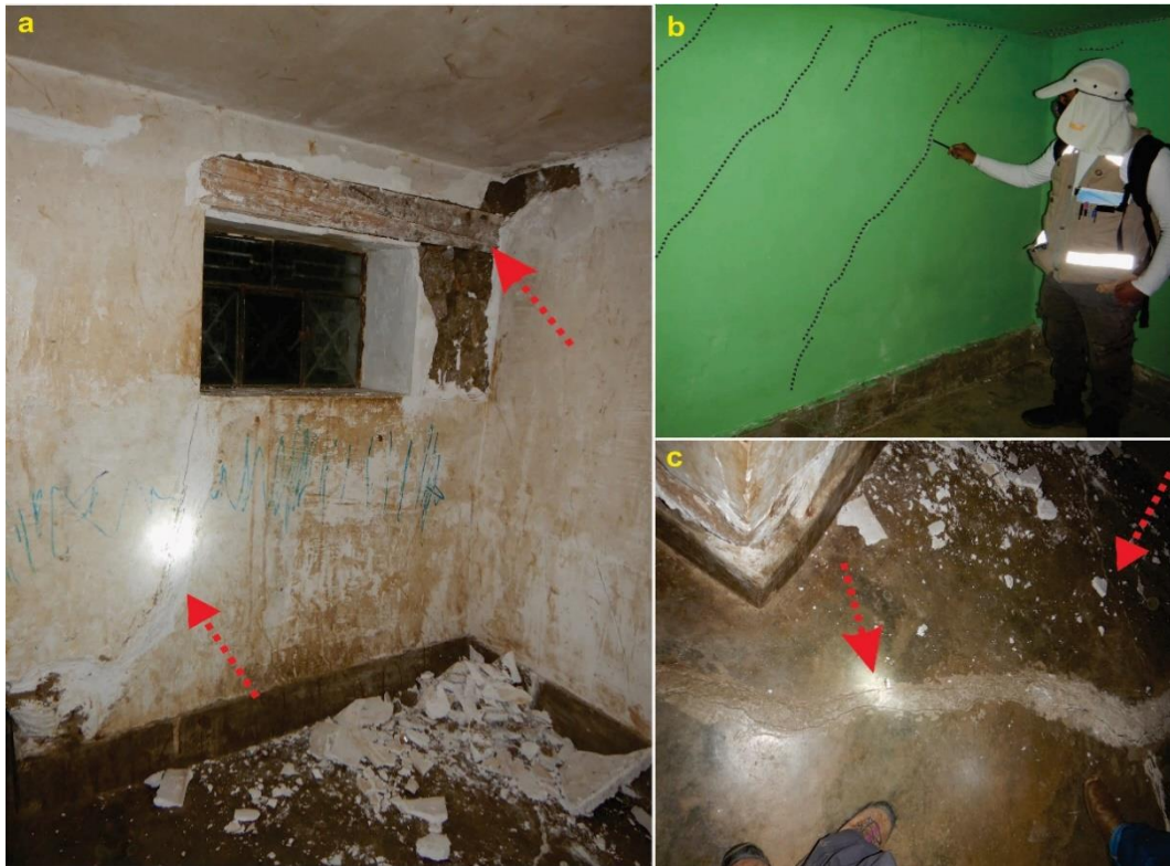
Figura 20. Se observa grietas en las paredes y piso de dos ambientes de la vivienda, que fueron selladas como medida correctiva, como indica las flechas de color rojo, ambientes que se encuentran deshabitados por medidas de seguridad.
