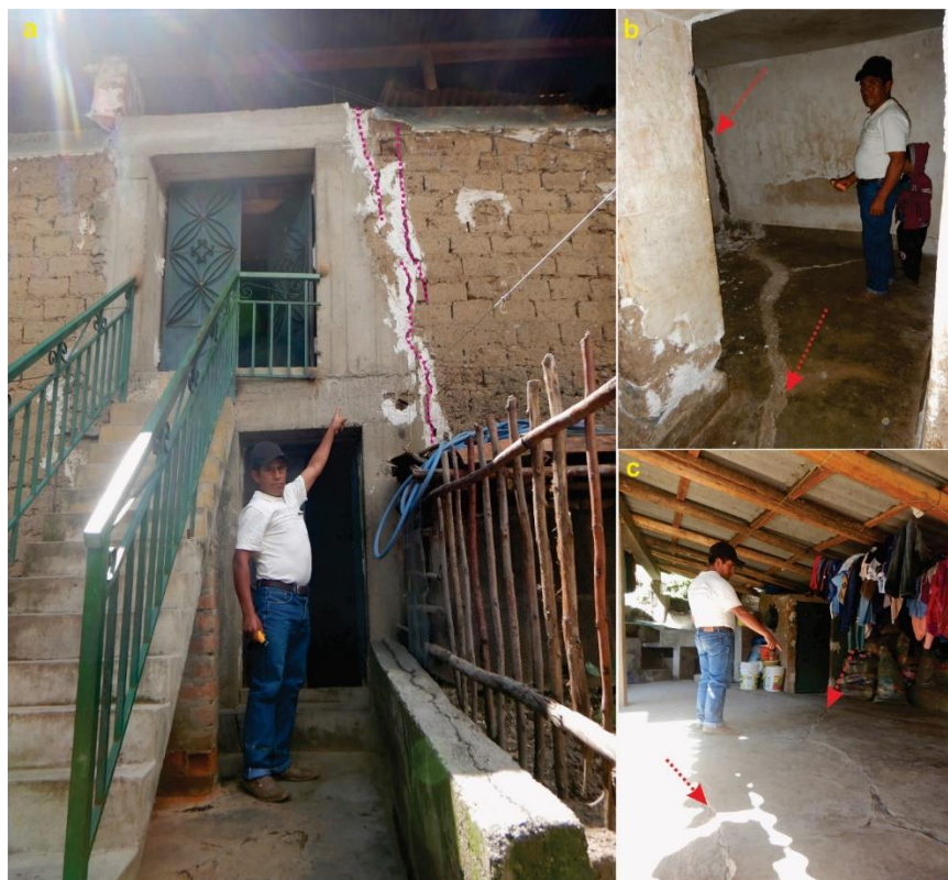
Figura 19. Vista donde se observa grietas en la fachada de su vivienda, el cual fue sellada con yeso; los agrietamientos de las paredes internas y en los pisos estas fueron selladas con cemento, estas grietas tienen aberturas de 0.5 a 0.12 cm
