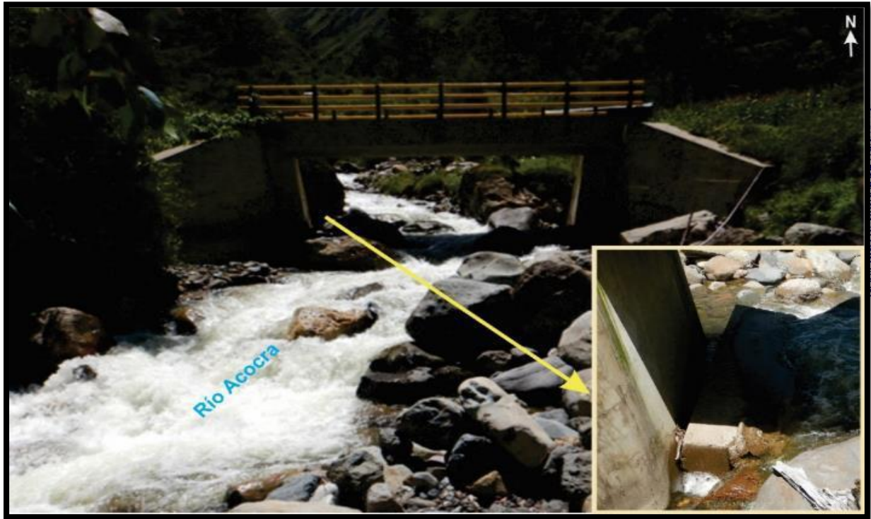
Imagen N° 24: Vista donde se observa afectaciones, en donde colapsó parte del estribo izquierdo del puente, que es otro de los accesos al centro poblado de Acocra.
