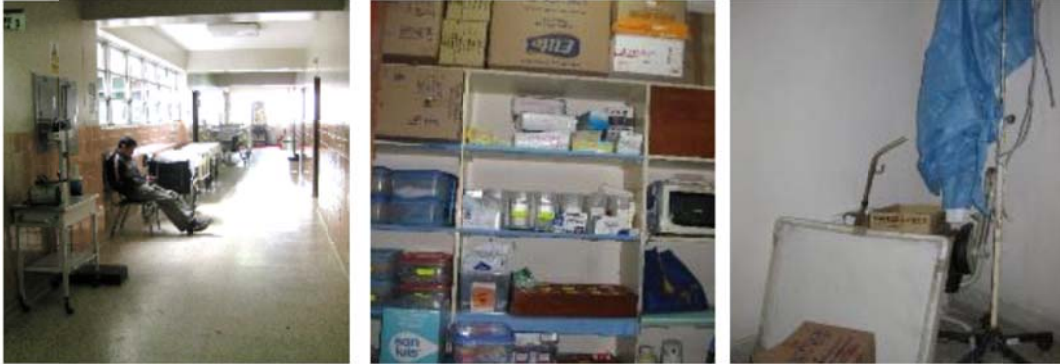
Figura 125: Izquierda: En el bloque C el equipo médico en el corredor que reduce el espacio de circulación. Centro y Derecha: En el bloque D hay Objetos del equipo médico no se encuentran sujetos en las estanterías, solamente están colocados, tienden al volcamiento ante movimiento sísmico.
