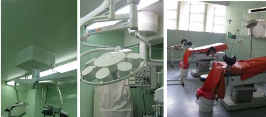
Figura 144: Izquierda y centro: En el bloque C en las zonas del Centro Quirúrgico(Entrepiso) los equipos médicos se encuentran fijados al techo. Derecha: En el bloque D del Centro Obstétrico(Segundo Piso) se encuentran equipos médicos que están fijados al piso y se encuentran en buen estado.
