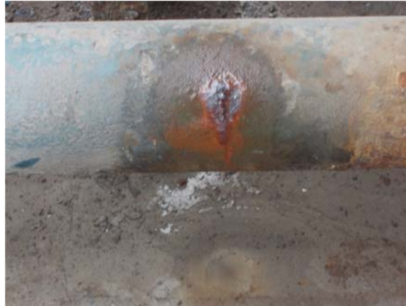
Figura 170. Tubería corroída con fuga de agua
