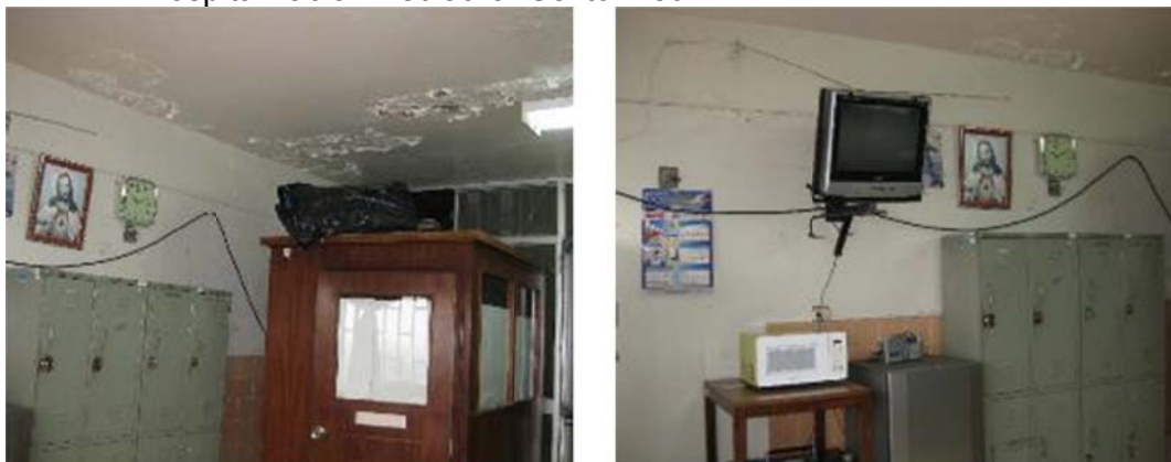
Figura 114: En el bloque C hay objetos colocados sobre los armarios tienden a un desplazamiento y volcamiento ante cualquier caso eventual. Televisor sujetado con un rack. Microondas solamente colocado en el mueble y no sujeto. Casilleros no sujetos al piso, techo o pared.
