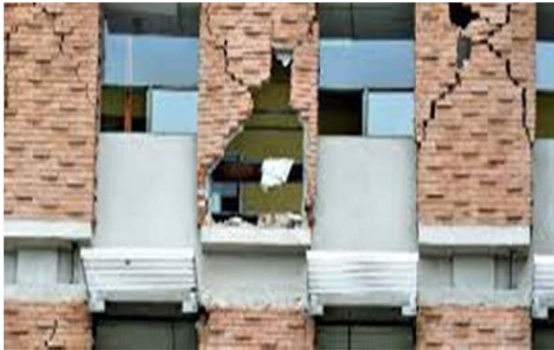
Figura 11 Baldosas en fachadas, que se desprenden por efecto de sismos intensos
