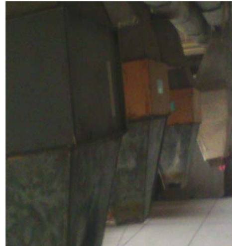
Figura 175 Instalaciones electromecánicas (ductos)
