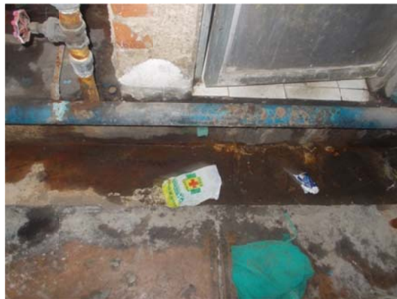
Figura 160. Tubería de Agua Blanda de F°G° corroída
