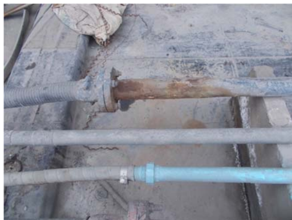
Figura 163. Tubería de agua en azotea corroída
