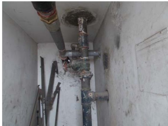
Figura 168. Tubería de salida sin uniones flexible
