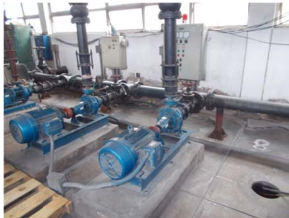
Figura 156. Alimentador de energía a tableros de bombas en forma inadecuada.
