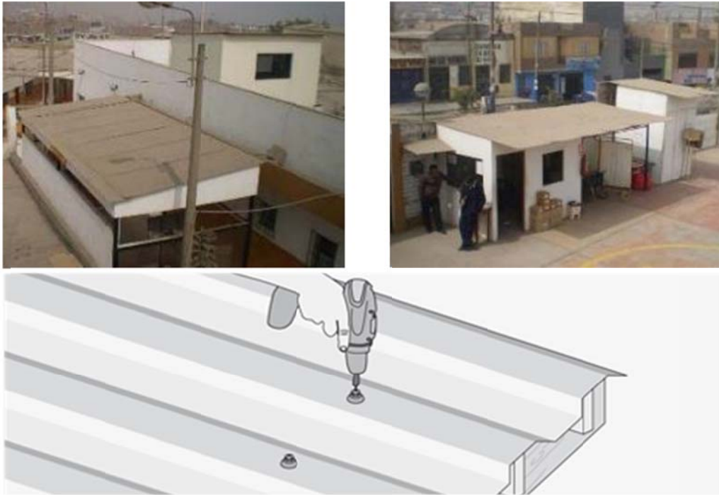
Figura 13 Techos ligeros que deben estar sujetos adecuadamente a fin evitar caídas o desprendimientos
