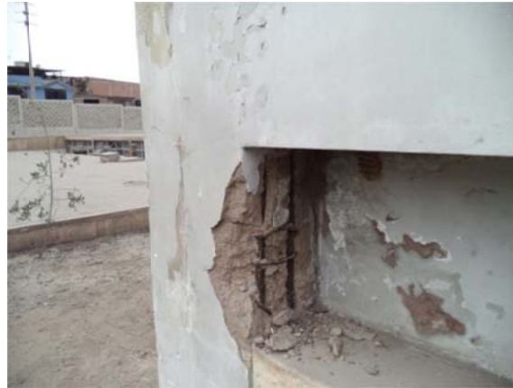
Figura 6. Refuerzo corroído en base de columna del 1er nivel.
