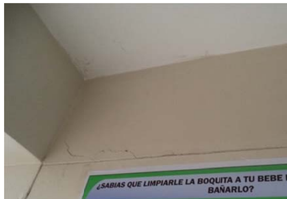
Figura 5. Grietas en vigas del 6to. nivel.
