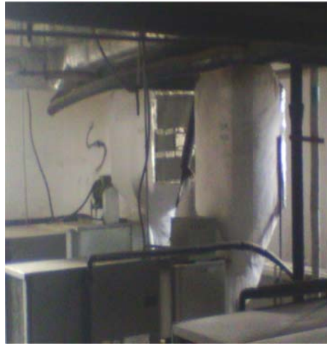
Figura 174 Instalaciones aire acondicionado
