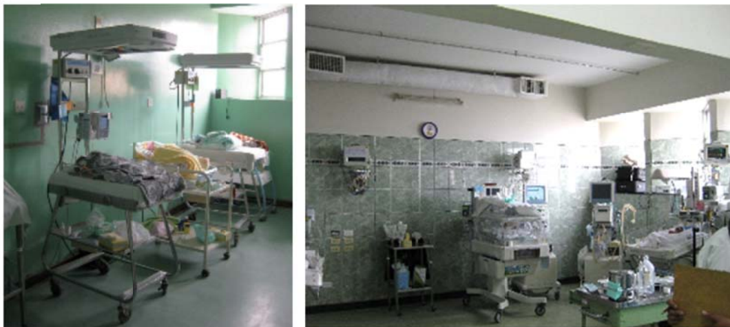
Figura 137: En el bloque D los equipos de monitoreo bien sujetos a una base y anclados a la pared. Algunos equipos son rodantes; sin embargo si tienen cables para poder conectarse a los enchufes colocados en la pared.
