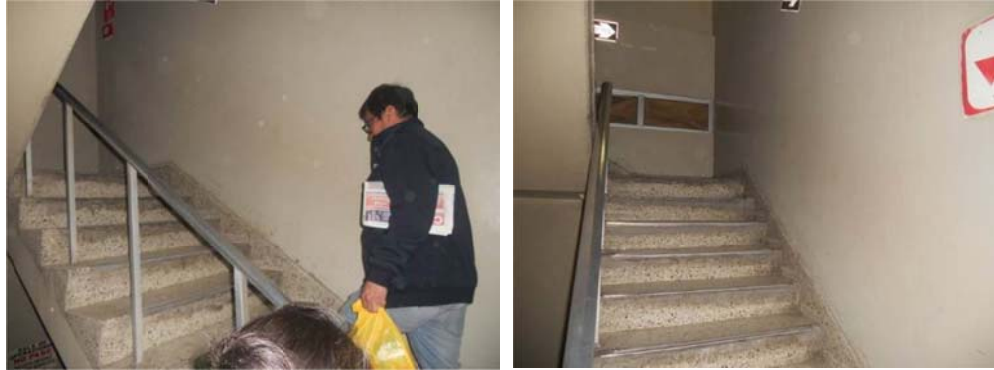
Figura 44 y Figura 45. Circulación vertical por escaleras estrechas.
