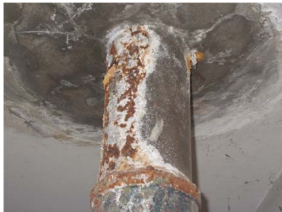
Figura 169. Tubería de salida corroída
