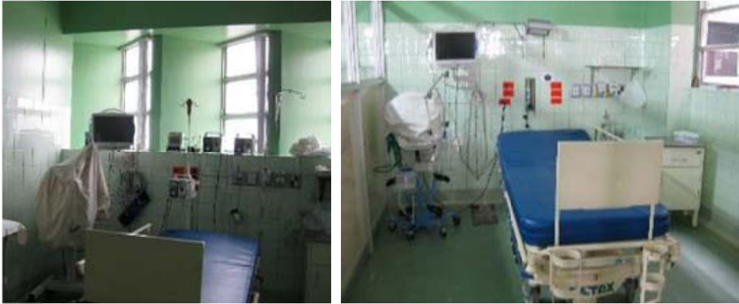
Figura 136: En el bloque C los monitores se encuentran bien sujetos a una base; sin embargo, algunos se encuentran colocados sobre un muro bajo. Hay un enredo entre los cables de los diferentes equipos que podrían ocasionar algún peligro.
