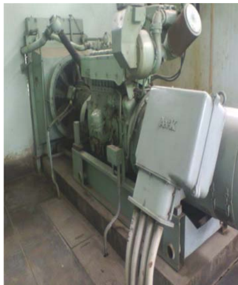
Figura 172 Grupo Electrógeno Inoperativo
