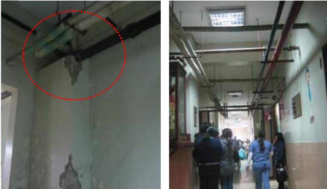
Figura 132: En el bloque A en encuentro de tuberías, se evidencia deterioro infraestructura por filtraciones. Además, los muros se encuentran en regular estado.
