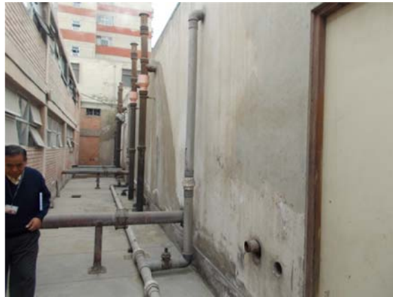
Figura 152. Tuberías con empalmes rígidos a tanques de agua
