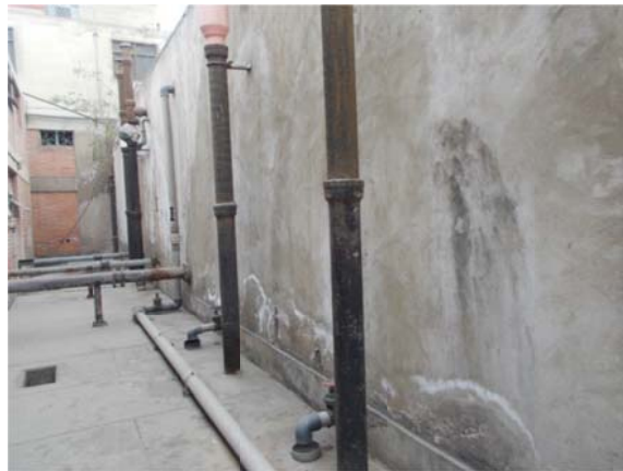
Figura 154. Empalme rígido de F°F° en salida de cisterna
