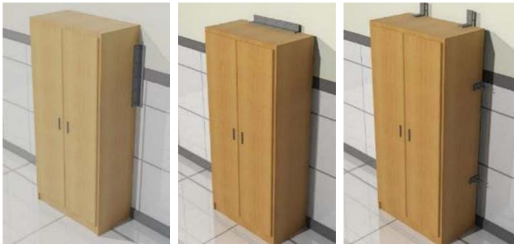
Figura 183: . Muebles y armarios deben estar fijados y asegurados afín de evitar caídas que afecten al personal de salud o que obstruyan salidas o corredores de evacuación.
