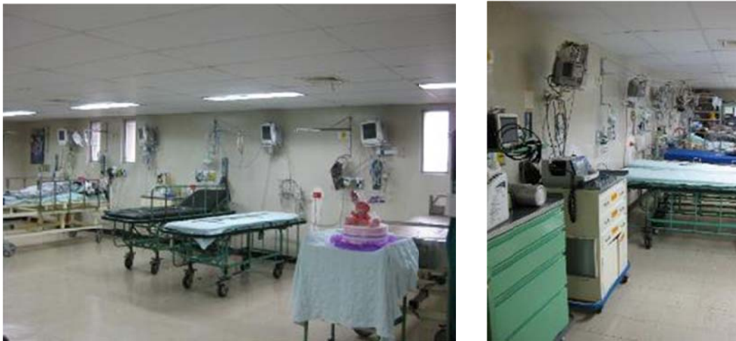
Figura 118: En el bloque D en Salas de Recuperación monitores adosados en pared con conexiones y cables no debidamente canalizados y otro caso solo colocados con riesgo de caída ante movimiento.
