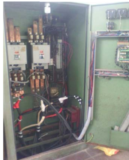
Figura 173 Tablero Eléctrico Principal
