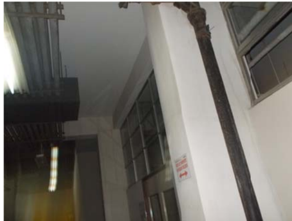
Figura 161. Tubería de desagüe de F°F° corroída
