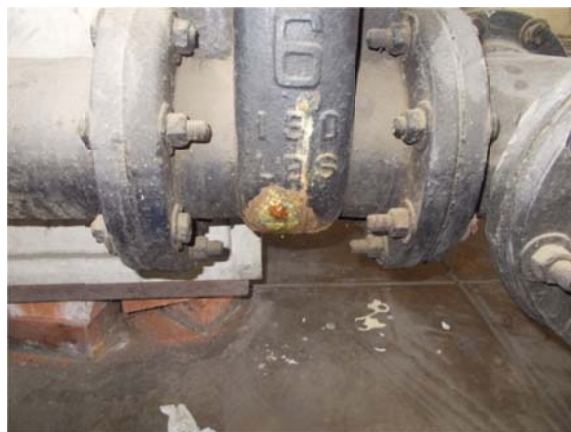
Figura 157. Válvulas corroídas en impulsión
