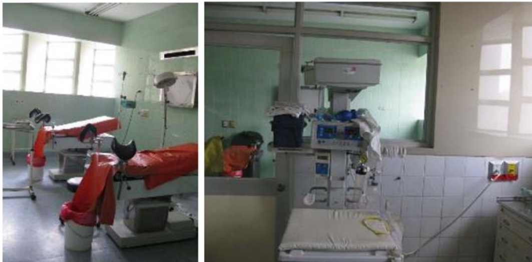
Figura 135: En el bloque D en la sala de partos, los equipos se encuentran anclados al piso y sin cables enredados. Los equipos de los recién nacidos no tienen anclaje por ser rodantes pero si se conectan para monitorear.
