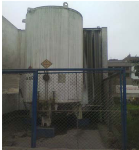
Figura 176 Tanque criogénico de O 2
