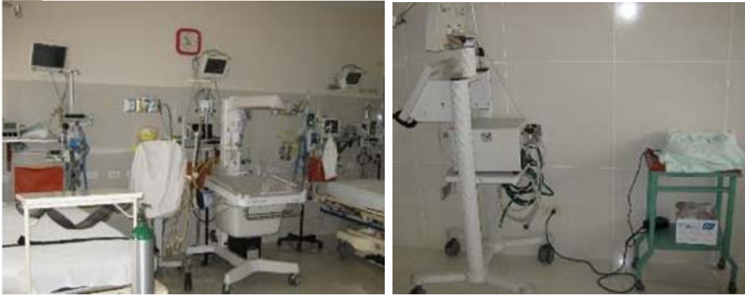
Figura 139: En el bloque D los equipos en pediatría se encuentran en buen estado, cuentan con un sistema de rodamiento y frenos asegurados que evitan que se desplacen. Los monitores se encuentran en la parte superior y sujetos a una base empotrada contra la pared.
