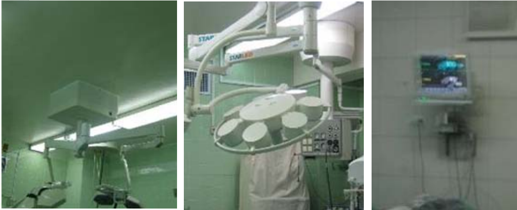
Figura 134: En el bloque C los equipos se encuentran bien anclados a las bases y techos. Asimismo, los monitores se encuentran bien sujetos a las bases que se empotran contra la pared.
