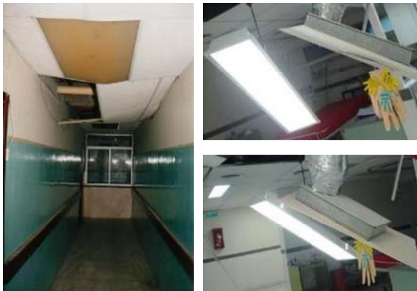
Figura 12 Falsos cielos rasos se desprenden por deficiencia en anclajes ante movimientos sísmicos
