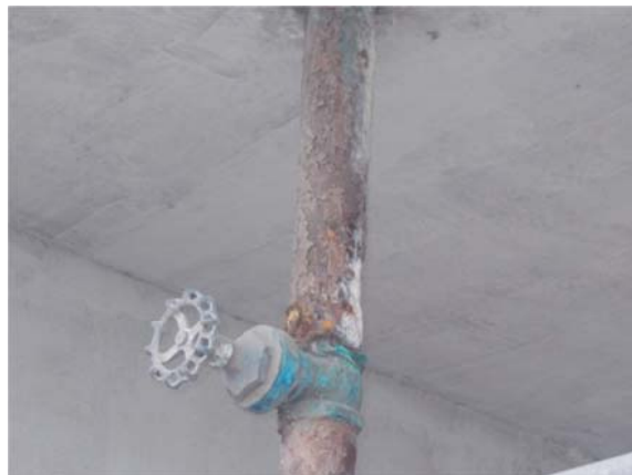
Figura 166. Tubería de salida a punto de colapsar
