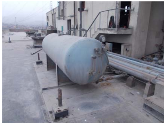
Figura 165. Equipos neumático colapsados
