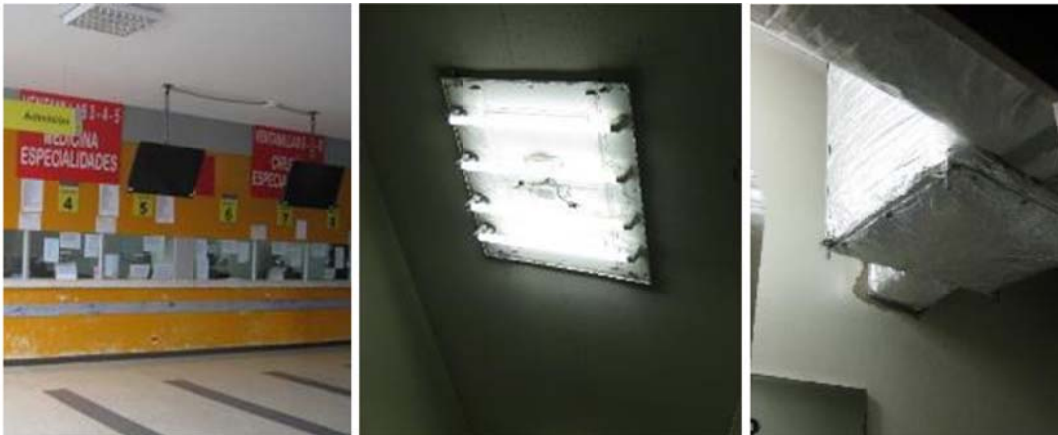
Figura 147: Izquierda: En el bloque I en Admisión (Primer Piso) se encuentran televisores suspendidos de unos cables del techo. Derecha: En el bloque C en la zona del Centro Quirúrgico (Entrepiso) las luminarias no cuentan con su panel de protección.
