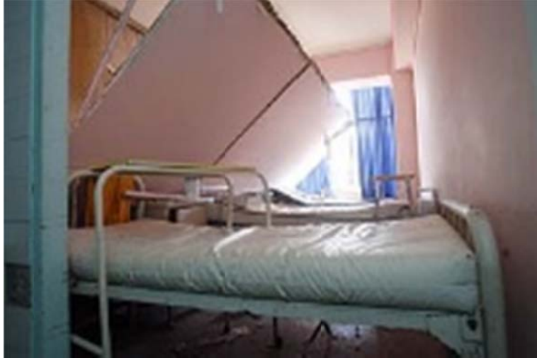
Figura 10 Tabiques no asegurados adecuadamente, corren el riesgo de deformaciones o caídas ante eventos adversos.
