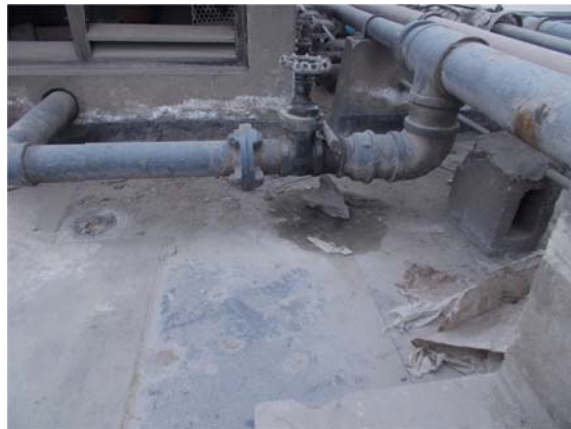
Figura 171. Válvula y accesorios corroídos con fuga de agua
