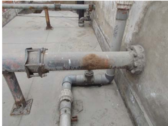
Figura 155. Empalme rígido a cisterna corroído
