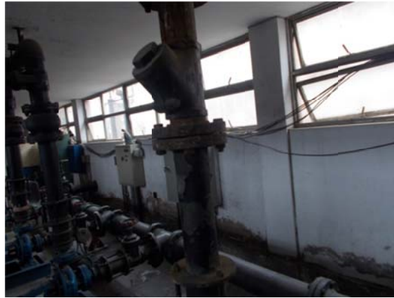
Figura 158. Tuberías corroídas en línea de impulsión
