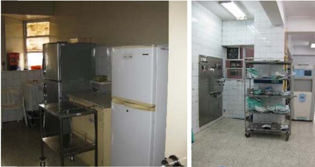
Figura 146: Izquierda: En el bloque D en la zona de hospitalización de Pediatría (Sexto Piso) se tienen refrigeradoras que están fijadas contra la pared. Derecha: De otro lado, en el bloque C en el centro de esterilización (Segundo Piso) los equipos para la esterilización de los instrumentos, insumos médicos están empotrados en la pared requiere mantenimiento periódico.
