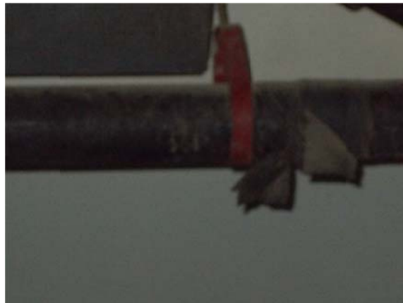
Figura 162. Tubería de desagüe de F°F° corroída
