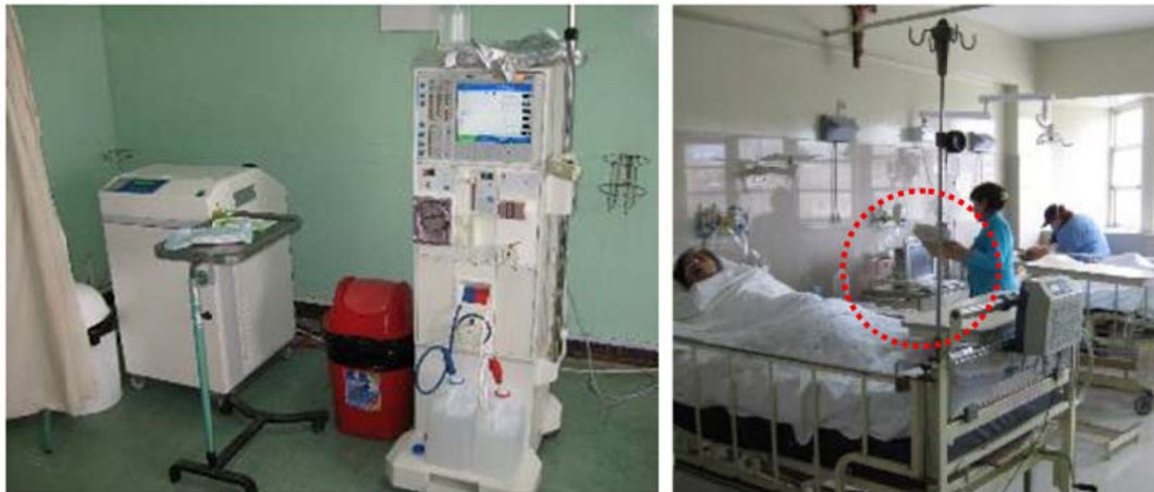
Figura 138: En el bloque C los equipos se encuentran en buenas condiciones, cuentan con sistema de rodamiento y frenos asegurados. Los monitores en los cuartos de hospitalización se encuentran solamente colocados sobre un mueble.
