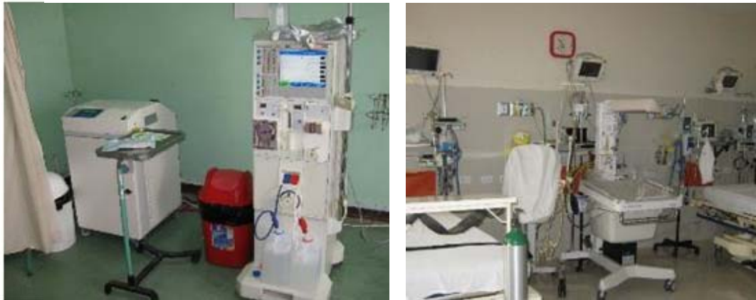
Figura 142: En el bloque D en UCI, Obstetricia Neonatología los equipos rodantes, como camillas, incubadoras, equipos de monitoreo, se encuentran en buen estado. Además, cuentan con un sistema de frenos asegurados para evitar su desplazamiento ante cualquier eventualidad y evitar riesgos.
