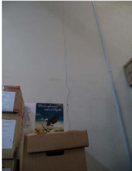
Figura 8. Grieta vertical en muro de sótano.
