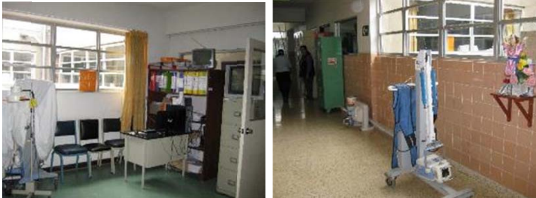
Figura 115: En el bloque D la estantería no sujeta al piso, pared o techo, tienden al volcamiento en casos eventuales. Otro factor, es el desplazamiento de los contenidos por no estar asegurados. Objetos colocados encima de la estantería sobrecargan la capacidad máxima del elemento. Elementos de cómputo no asegurados al mueble, estos se encuentran solamente colocados. Derecha. Armarios y estanterías en corredor que obstruyen corredor de circulación, riesgo de volcamiento ante movimientos sísmicos.
