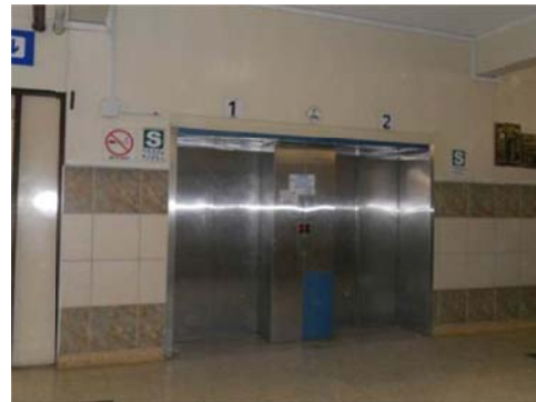
Figura 40. Ascensores con más de 30 años de antigüedad, frecuentemente inoperativos.
