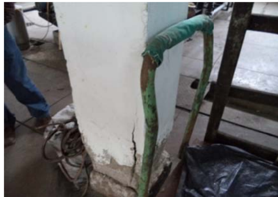
Figura 7. Deterioro de las columnas.
