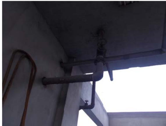
Figura 167. Tubería de salida sin uniones flexibles en tanque elevado
