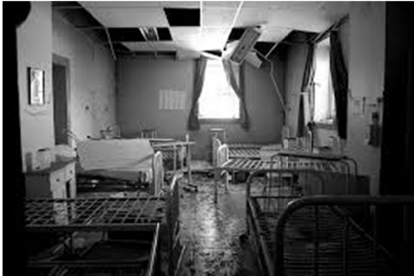
Figura 16 Luminarias no sujetadas adecuadamente en techo ante movimientos sísmicos, se caen e incrementan el peso del falso cielo raso provocando colapso del sistema.
