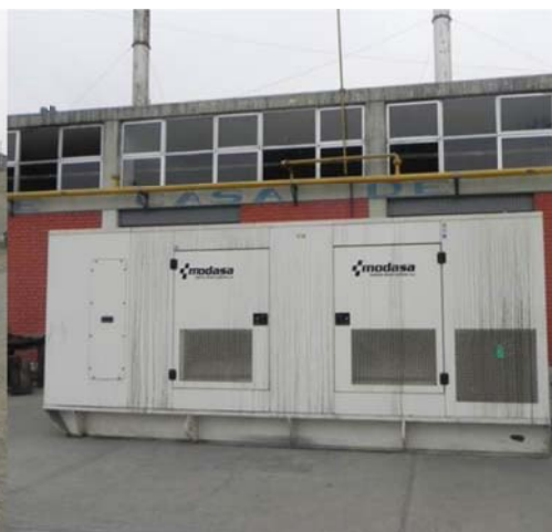
Figura 50. Grupo electrógeno dual para abastecer las áreas de expansión (en proceso de instalación).
