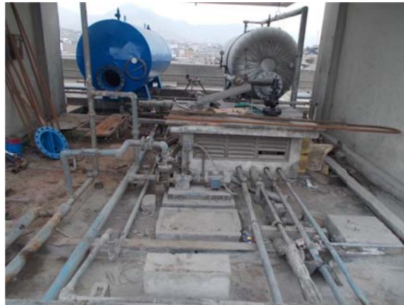
Figura 164. Equipos colapsados de agua caliente
