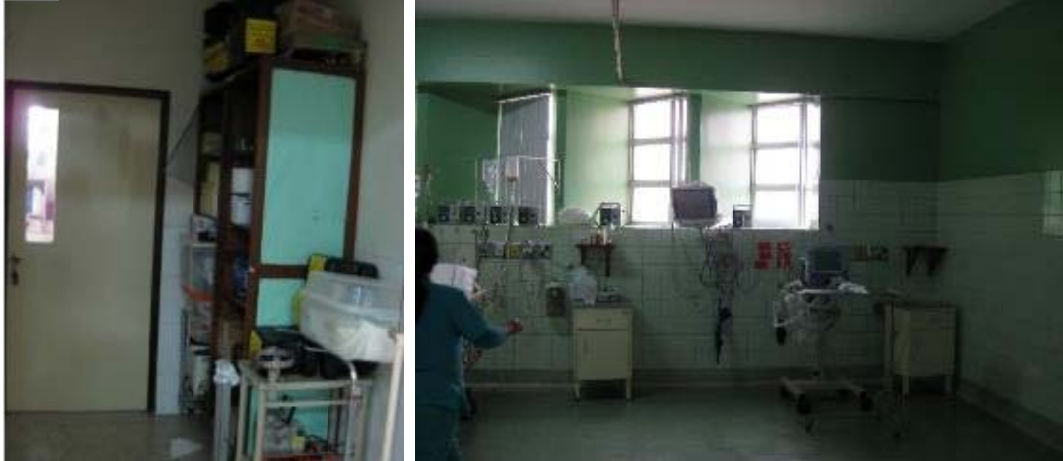
Figura 122: En el bloque C el equipo médico solamente colocado sobre la estantería y no sujetos con algún elemento para evitar su desplazamiento. Algunos equipos médicos si se encuentran sujetos a la pared, sin embargo otros simplemente están colocados sobre el muro.
