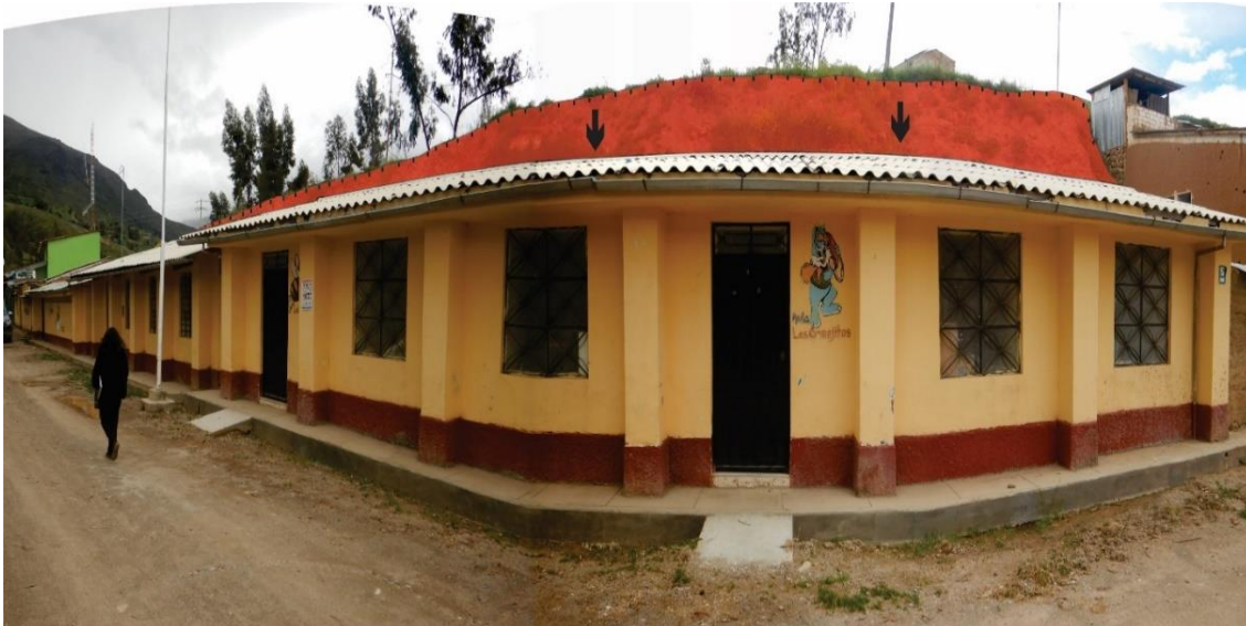
Figura 13. Vista con dirección al sur desde la plaza central del distrito, donde se ha delimitado con línea roja la escarpa del derrumbe, ubicado a solo 2 metros de la I.E.I. N°265 Inmaculada Niña María.
