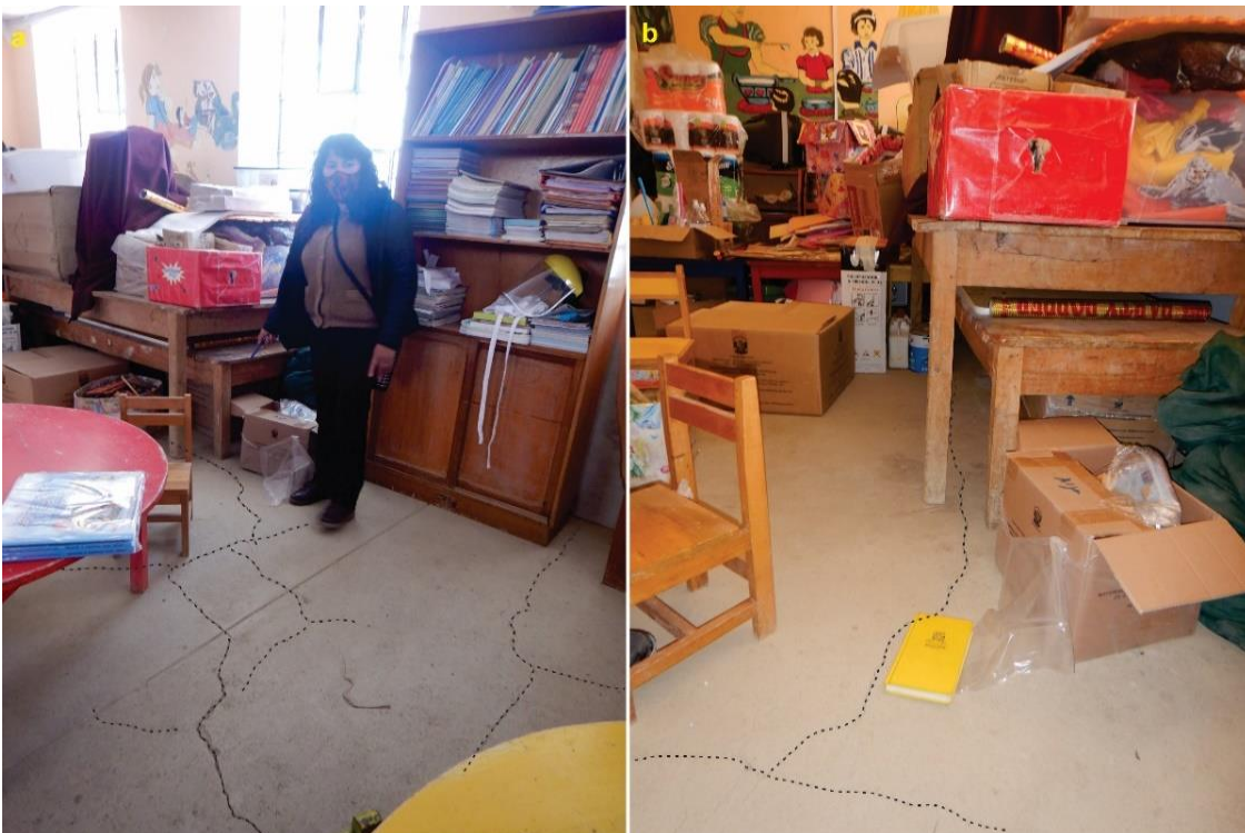
Figura 17. Ambiente deshabitado por medida de seguridad, debido a las presencias de agrietamientos en el piso y techo.
