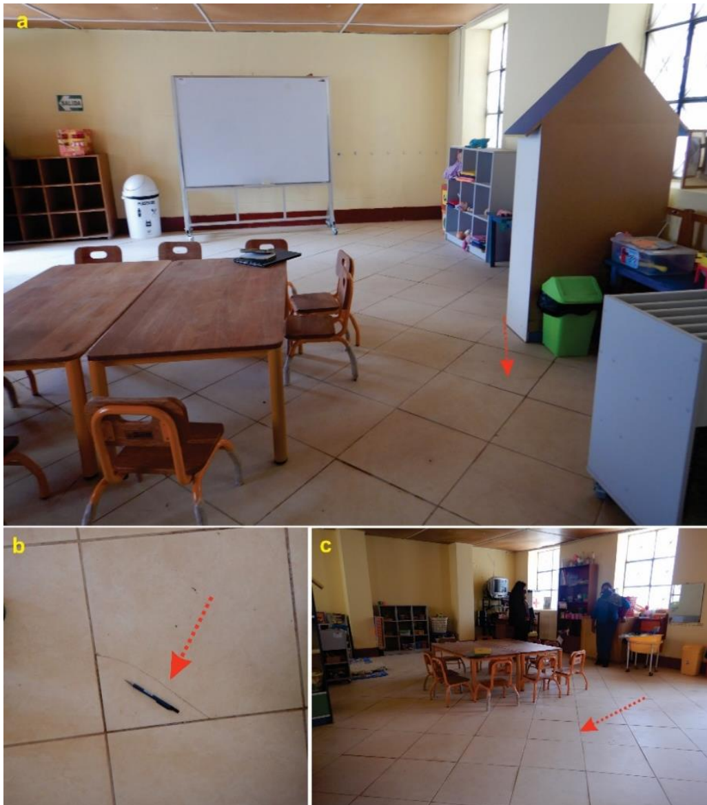
Figura 18. En el tercer ambiente, aquí se pudo evidenciar que la loseta instalada hace dos años, ya presenta agrietamiento en el piso, también se observó que la loseta presenta un desnivel.
