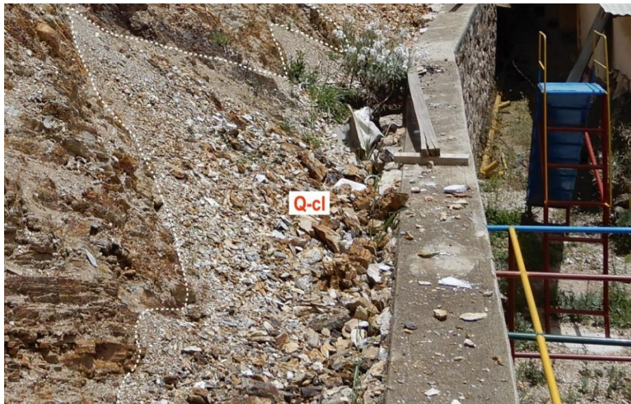
Figura 6. Depósitos coluviales, constituido por fragmentos rocosos angulosos heterométricos y de naturaleza litológica homogénea. Carecen de relleno, sueltos y sin cohesión, se ubica en las coordenadas UTM 8917538 N, 213796 E, con una altitud de 3461 m s.n.m.
