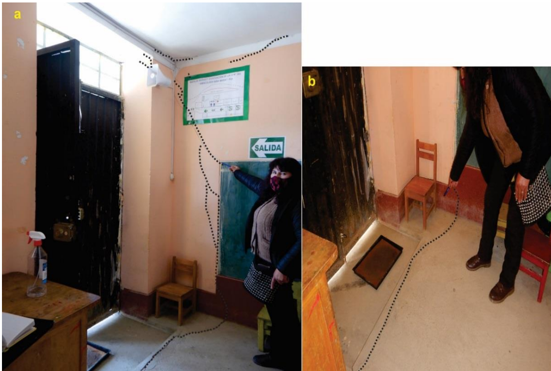
Figura 16. El primer ambiente presenta agrietamientos menores a 0.02 cm, con profundidades similares y longitudes de hasta 1m, en las paredes y pisos.
