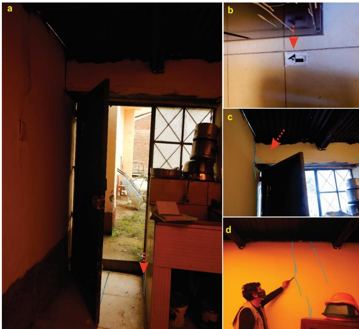
Figura 15. Se aprecia agrietamientos en la pared y piso del ambiente que era utilizado para la preparación de alimentos del alumnado de dicha institución, hoy deshabitado.
