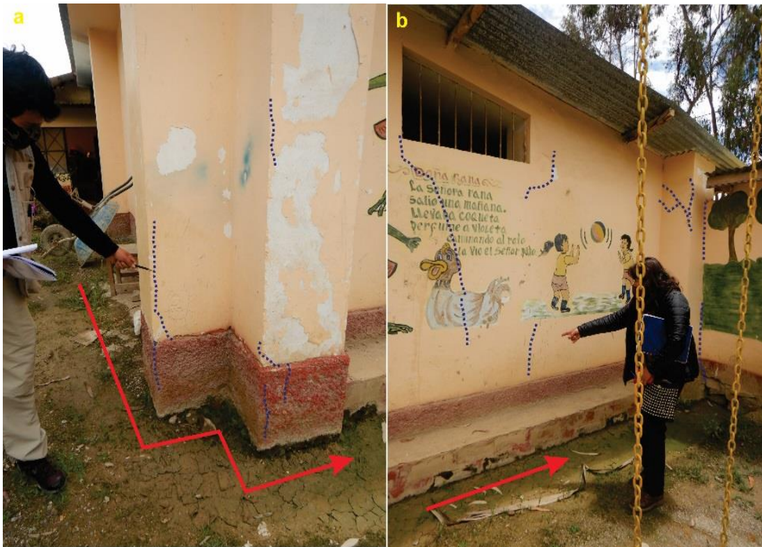
Figura 19. Es importante mencionar que la pared de la institución presenta humedad, esto se debe a que el techo, no cuenta con canaleta de drenaje por donde discorra el agua de las lluvias, por consiguiente, se está generando empozamiento principalmente en temporadas de lluvias. Se recomienda la instalación de un canal.
