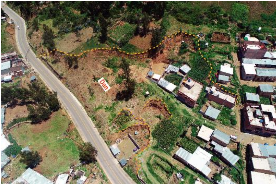
Figura 8. Vista de la sub unidad de depósitos antrópicos, tomada con el dron; donde se observa cortes de talud para la construcción de nuevas viviendas.
