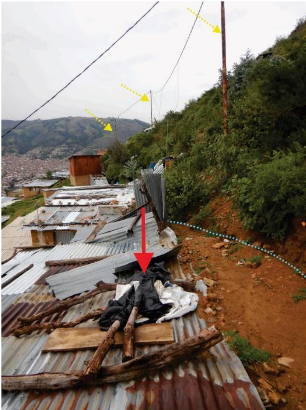
Figura 13. Vista donde se observa vivienda destruida por la caída de roca (señalada con flecha roja), actualmente reconstruida, así mismo se apreció postes de tendido eléctrico que podrían ser afectados.
