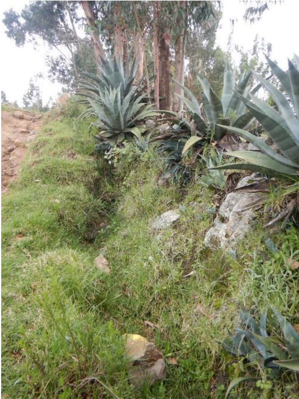
Fotografía 2. Se observa canal sin revestimiento, con dirección hacia las viviendas. El canal tiene un ancho de 30 cm y con una profundidad que varía entre 20 a 35 cm.
