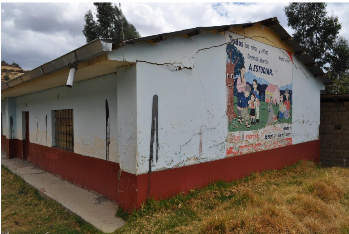
Institución educativa en desuso, se puede apreciar el estado totalmente fracturado es que se encuentra, sector Huayllapata.
