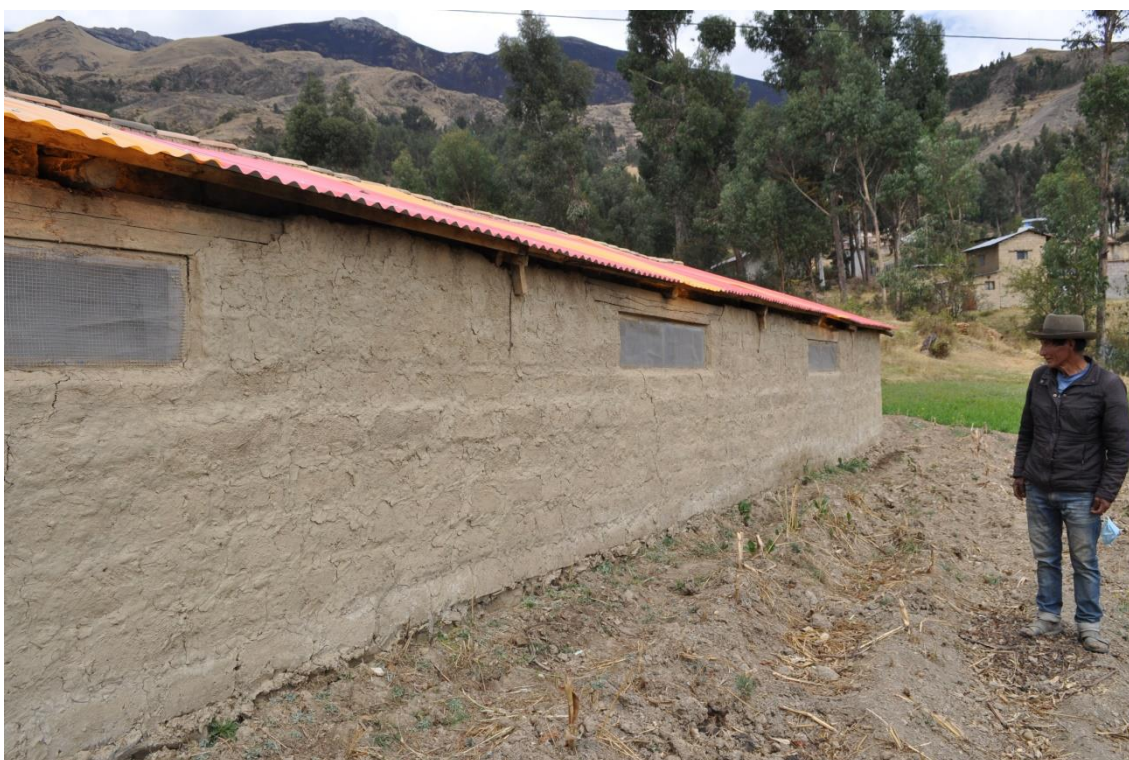
Galpón de cuyes, construcción reciente, con fisuras en las paredes, sector Huayllapata.
