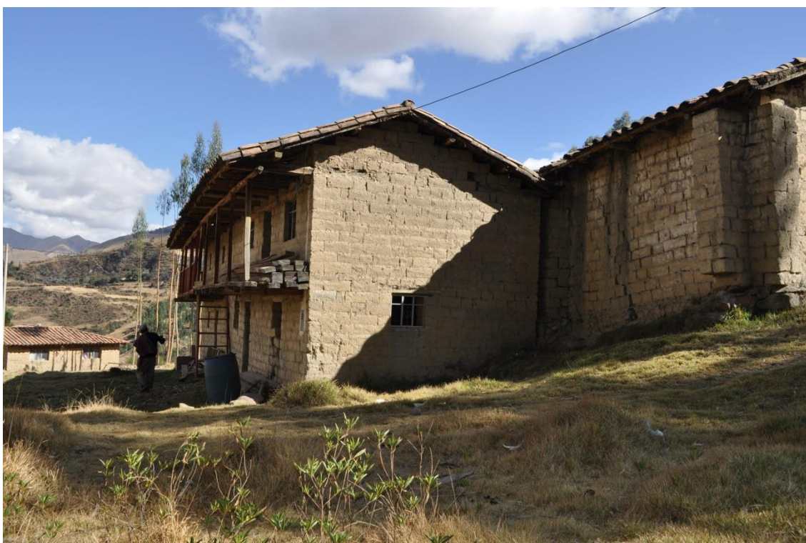
Viviendas con fisuras en las paredes, en terrenos con pendiente suave, sector de Órcac.
