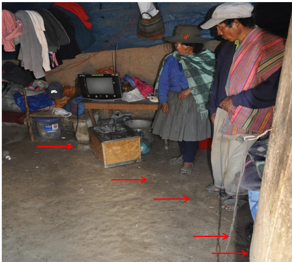
Fisuras en el piso de vivienda, sector Órcac.
