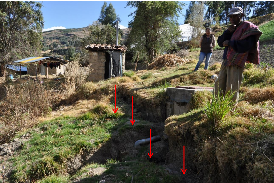
Fisuras en la cabecera del deslizamiento (DAO-4), sector de Órcac, afecta a viviendas y captaciones de agua.
