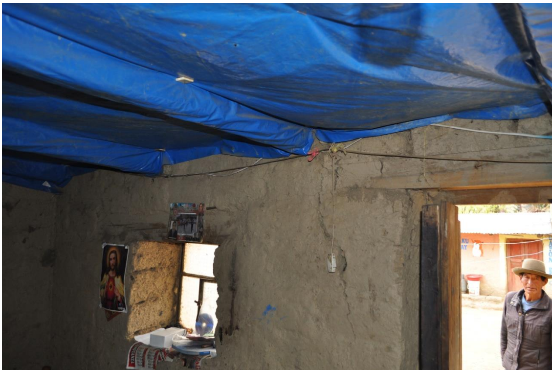
Vivienda con fisuras en la pared, sector Huayllapata
