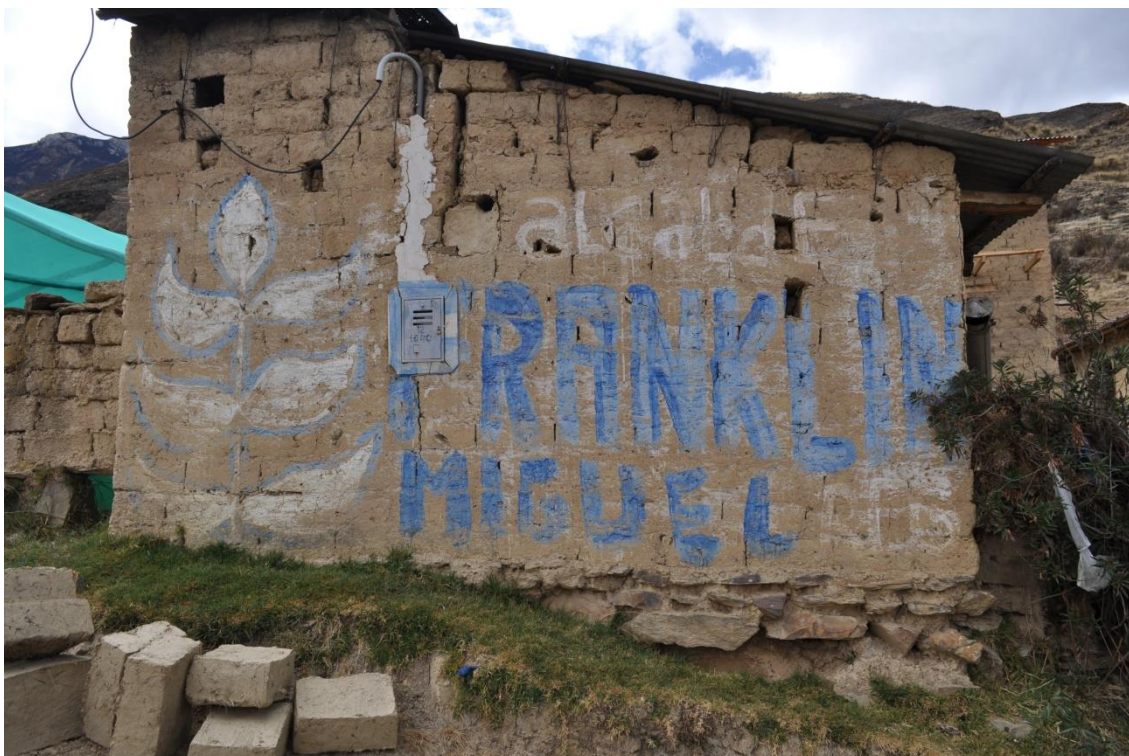
Fisuras en paredes de viviendas, sector de Huancané
