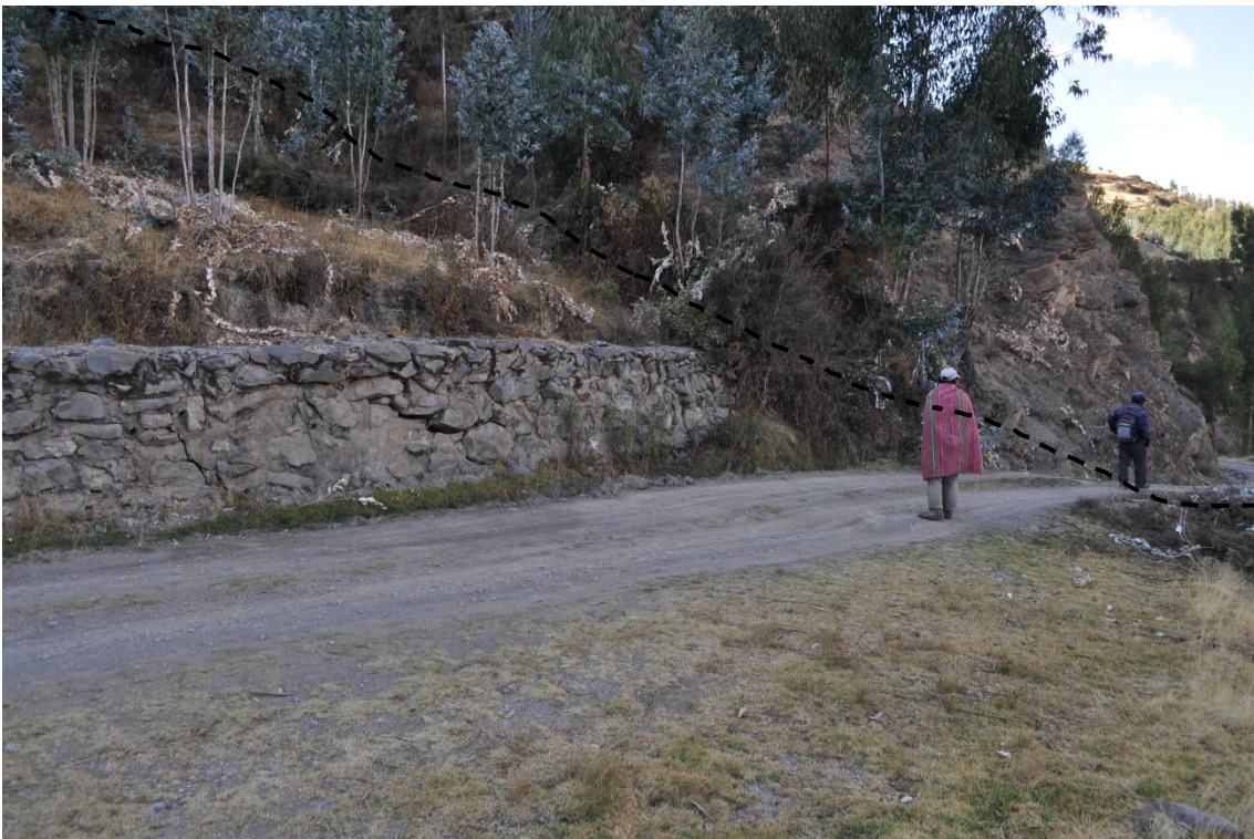
Muro de contención para estabilización de talud, completamente fisurado, sector de Órcac, (UTM: 229,780E; 8465,752N), se observa que el deslizamiento también compromete a la carretera.
