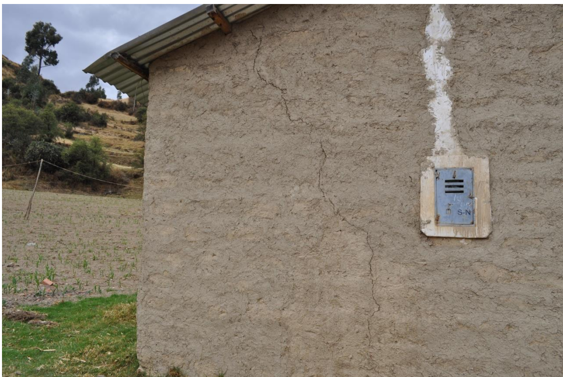
Fisuras en pared de construcción reciente, sector Huayllapata,
