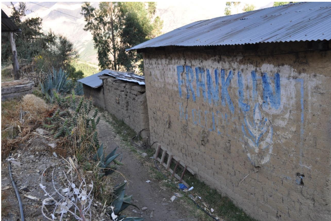
Vivienda con fisuras en la pared, sector Órcac
