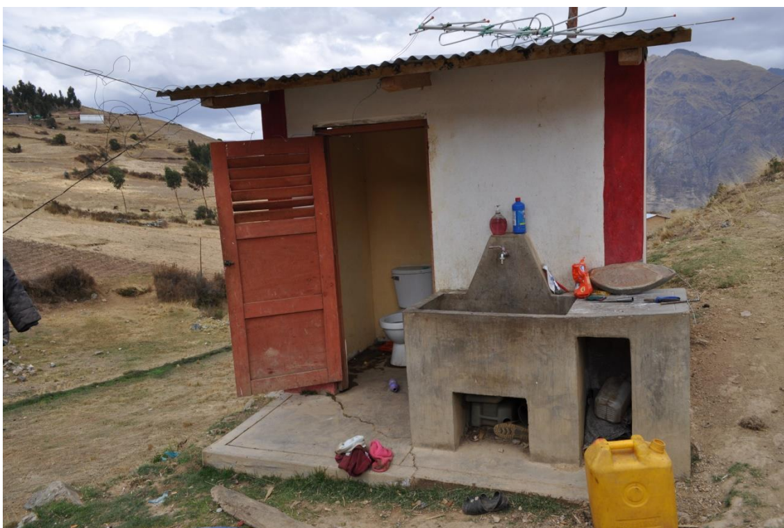
Fisuras en construcciones, sector de Huancané
