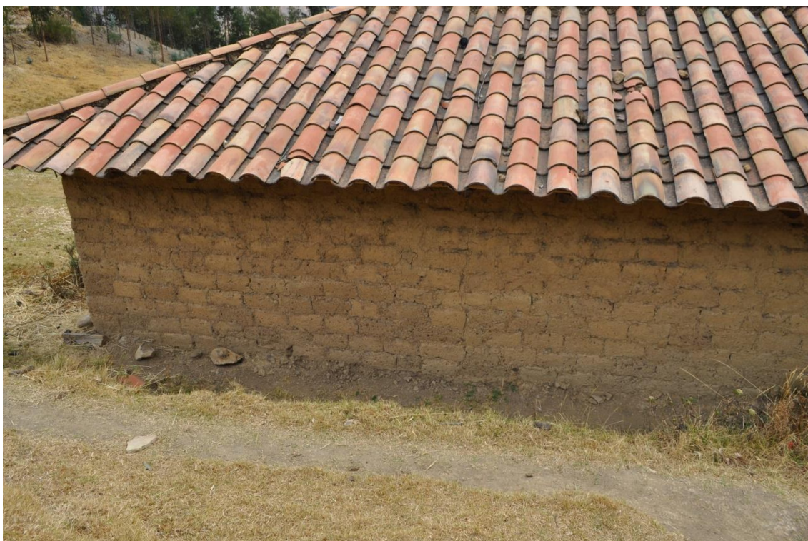
Vivienda de muy reciente construcción con fisuras en la pared, sector Huayllapata.
