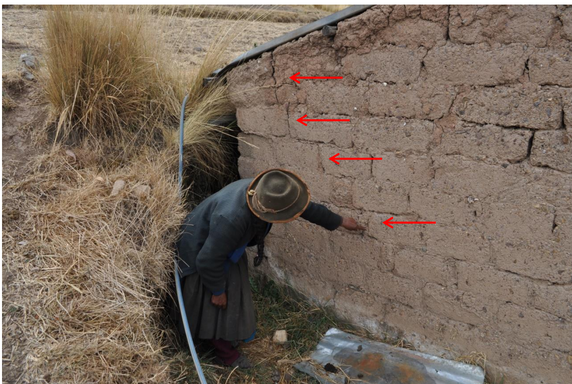
Vivienda ubicada cerca al deslizamiento (DAH-1), las flechas rojas muestran fisuras en la pared.
