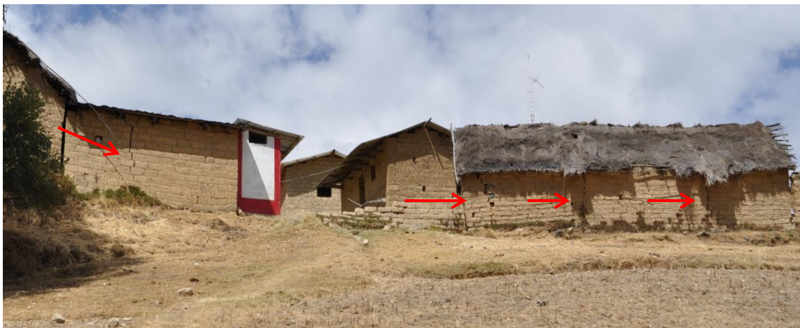
Fisuras en paredes de viviendas, sector de Huancané
