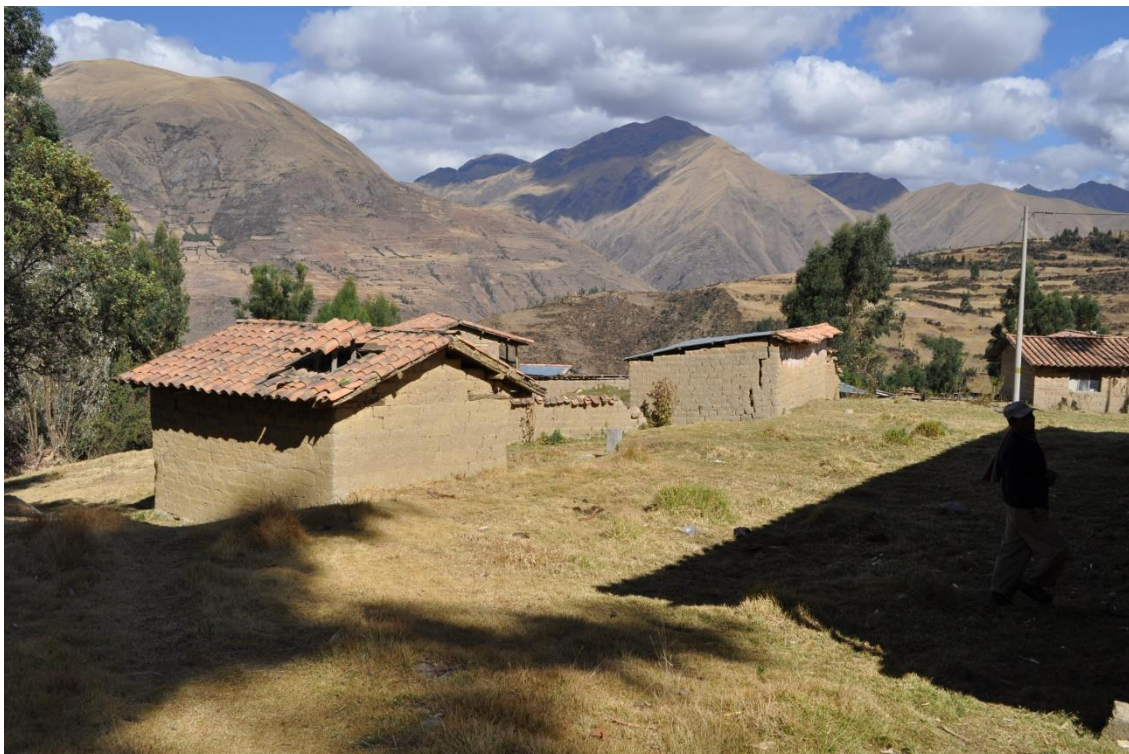
Viviendas con fisuras en las paredes, en terrenos con pendiente suave, sector de Órcac.
