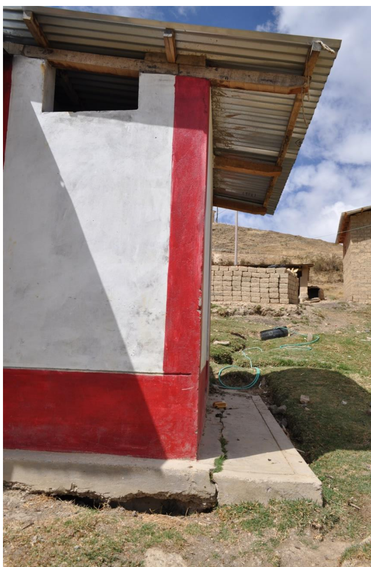
Piso con hundimientos en estructura reciente, se observa cómo se va destrozando la edificación, sector de Huancané
