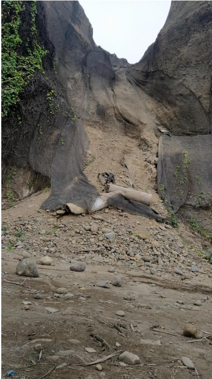
Fotografía 3: Derrumbes de dimensiones pequeñas ubicado en el circuito de playas - Frente a la playa Los Pavos. Obsérvese la ruptura de las geomallas de protección.
