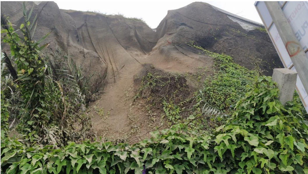
Fotografía 5: Caída de rocas ubicado en el Circuito de playas, frente a playa Redondo I, es de pequeña magnitud y no evidencia haber generado daños significativos.
