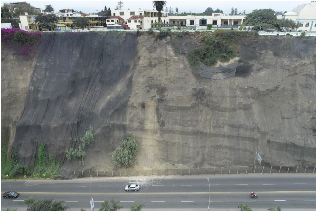
Fotografía 1: Derrumbe ubicado en la Av. Malecón Grau - Frente a playa Agua Dulce.
