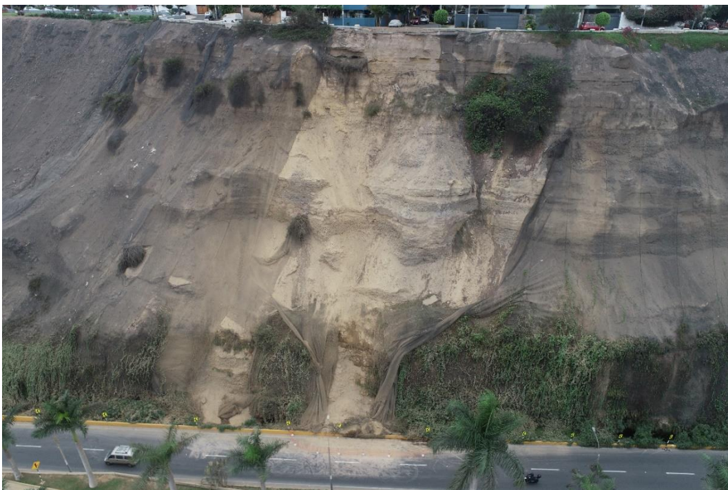
Fotografía 2: Derrumbes 2 y 3 continuos, cuyo efecto principal ha causado la ruptura de la malla de seguridad, y la obstrucción temporal de la Av. Malecón Grau en un tramo de 20 m
