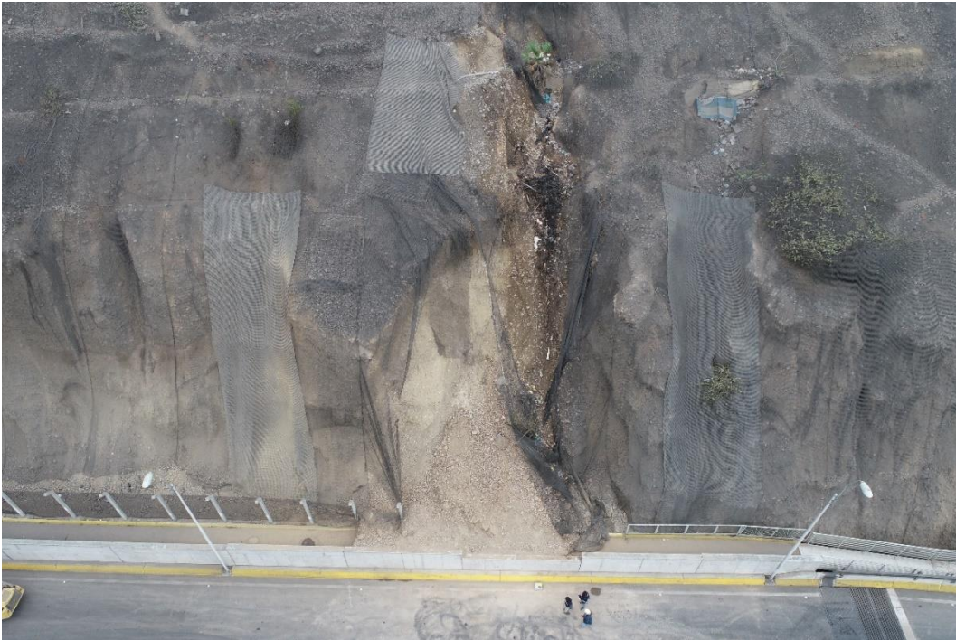
Fotografía 4: Derrumbe ubicado en el carril de subida del viaducto Armendáriz. Ocasionó la ruptura de la malla de seguridad y afectó la vía peatonal y vehicular en un tramo de 22 m.
