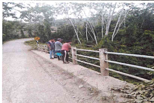
FOTO 02: Se aprecia el puente Sinkiveni de estructura de concreto armado que es erosionado en las épocas de avenida del rio Sinkiveni.
