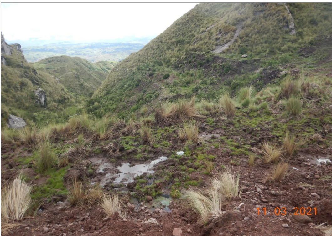
Fotografía 3. Vista de surgencia de agua al pie de la presa, producto de la infiltración. Con coordenadas UTM (WGS 84): 818887 E, 8503241 N, a 3974 m s.n.m.
