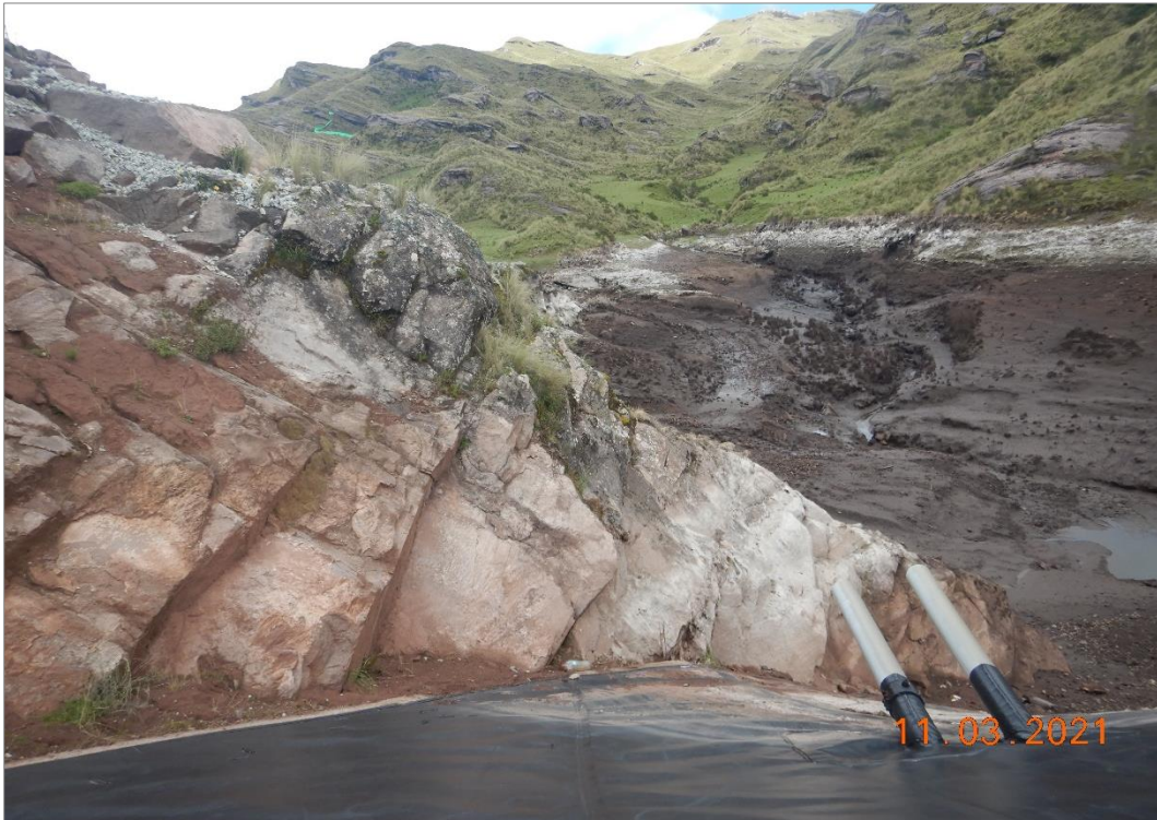
Fotografía 1. Vista al noroeste de la represa Huayllay, el afloramiento rocoso se encuentra ligeramente meteorizada y medianamente fracturada debido a la existencia de una falla geológica, con coordenadas UTM (WGS 84): 818919 E, 8503252 N, a 3974 m s.n.m.
