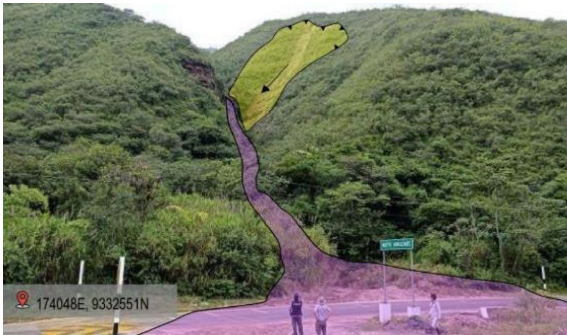
Figura 12. Vista de la zona de deslizamiento y flujos de detritos que afectó la vía Chachapoyas-Pedro Ruiz.
