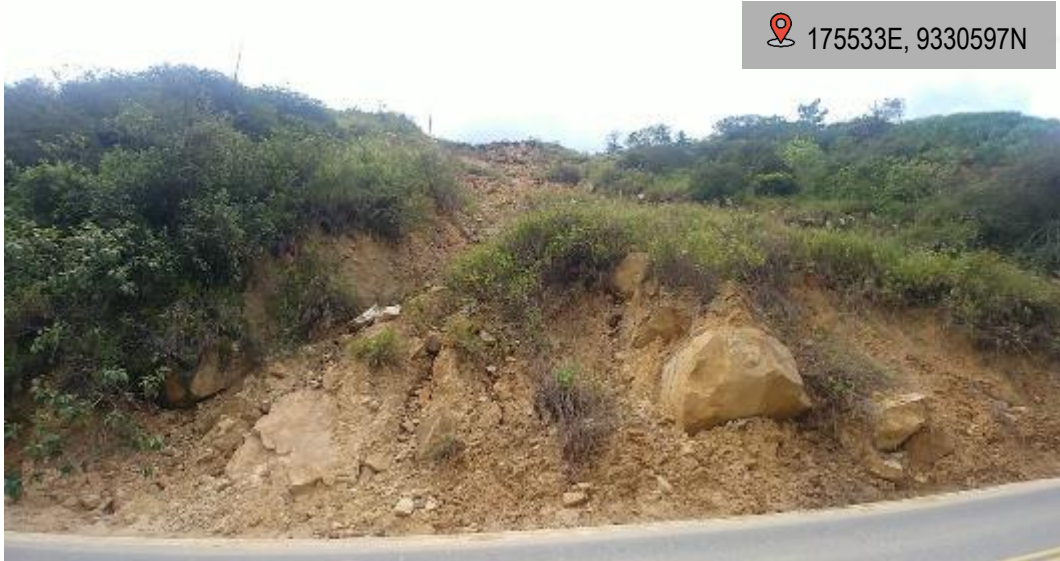
Figura 28. Depósitos coluvio deluviales producto de antiguos deslizamientos y que fueron reactivados en el mes de abril en temporada de lluvias.
