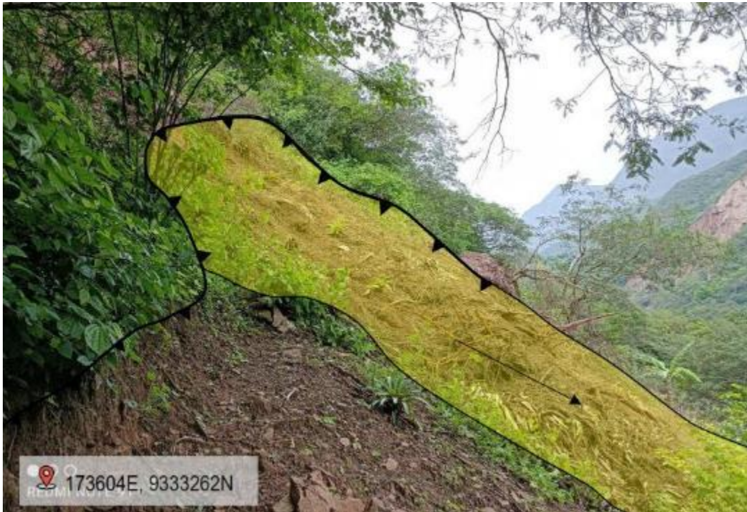
Figura 08. Deslizamiento que impacta en el kilómetro 12+100, en la carretera Chachapoyas-Pedro Ruiz.
