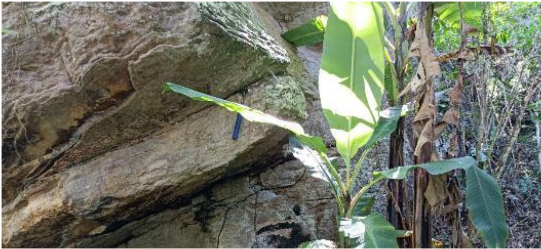
Figura 04. Areniscas y lutitas muy fracturadas en las inmediaciones del sector Vista Hermosa.
