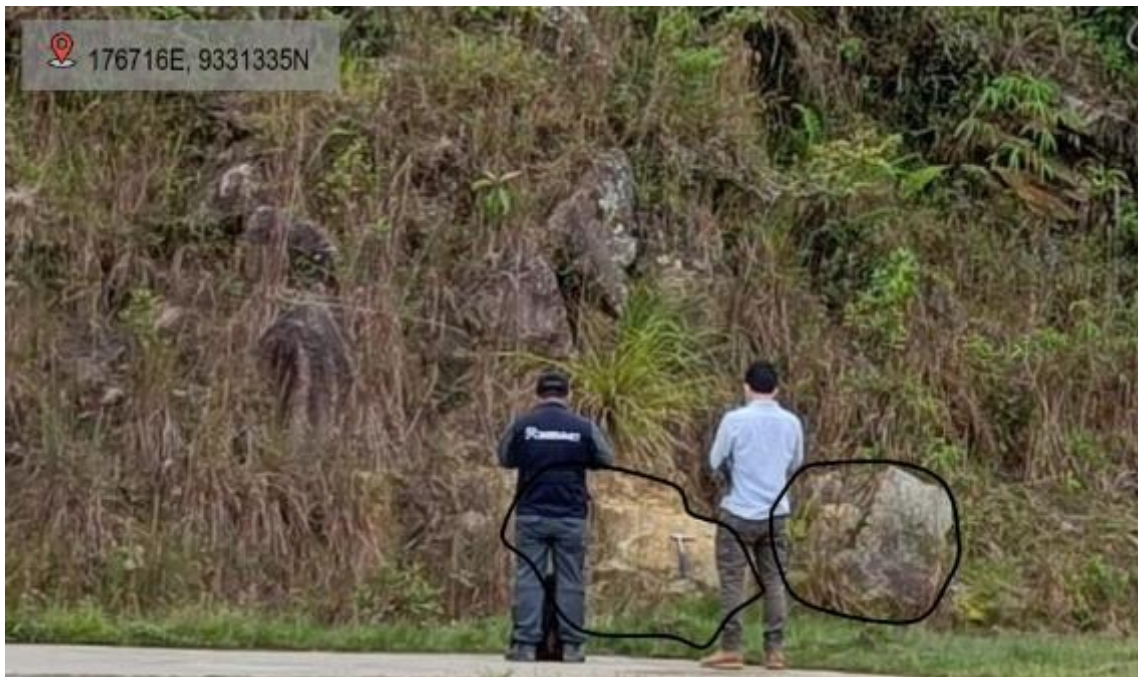
Figura 24. Bloques caídos hacia la loza deportiva.
