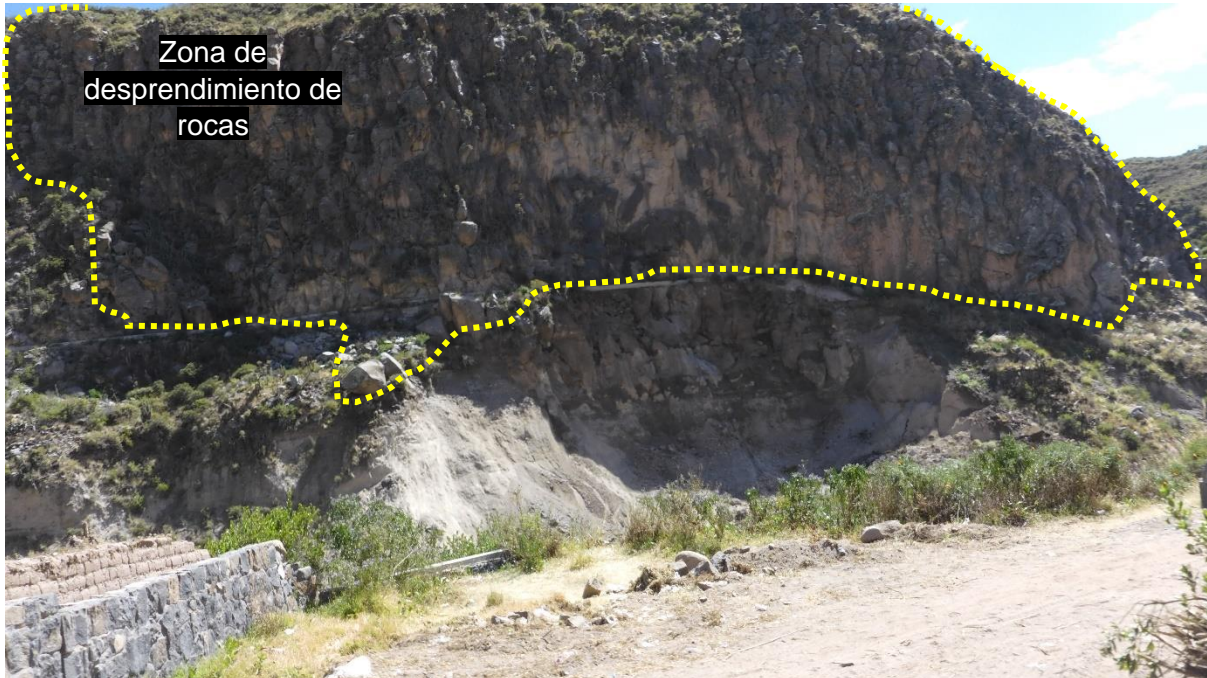
Figura 26. Se aprecian las zonas de desprendimiento de rocas, se ubican en el punto UTM: (E: 221302, N: 8270378)
