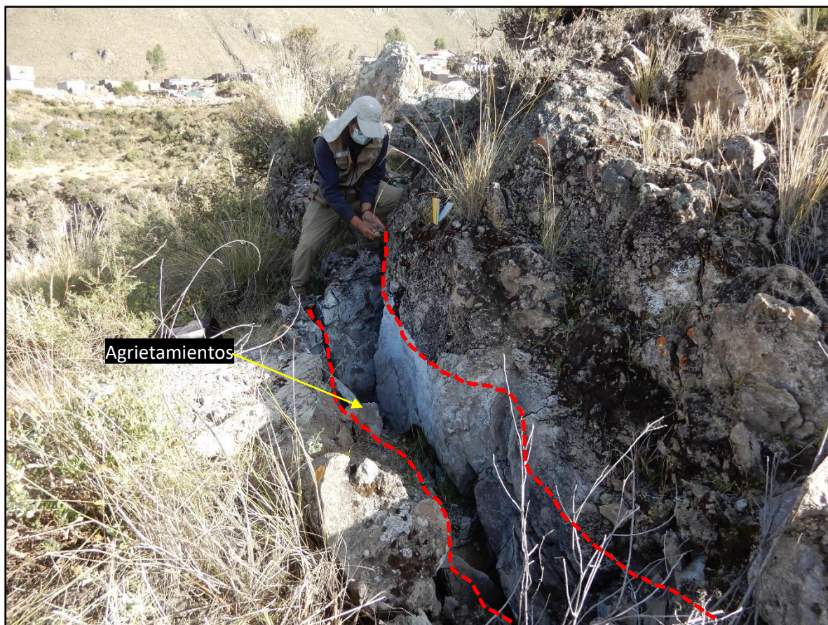
Figura 22. Agrietamiento en el sector Munaypata, (coordenadas UTM E: 220393, N: 8269972).
