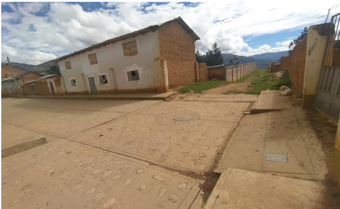
Fotografía N° 13- Estado actual del cruce entre el Jr. San Sebastian y Jr. Porvenir. Mz C (centro) y Manzana J (derecha, donde se encuentra el centro de salud colapsado).
