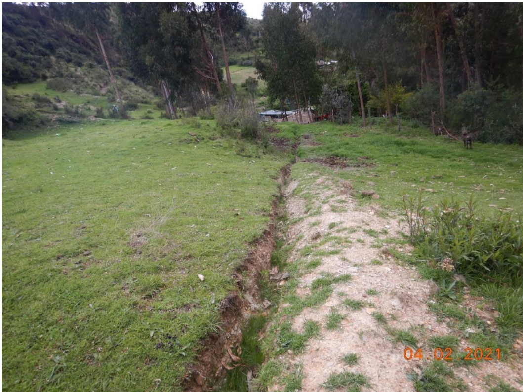
Fotografía 5. Canal de drenaje sin revestimientos ubicado en el cuerpo del antiguo deslizamiento compuesto. Coordenadas UTM (WGS 84): 229274 E, 8468662 N a 3450 m s.n.m.
