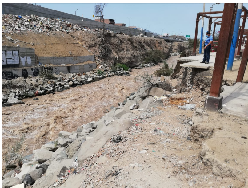
Se observa que parte del área del polideportivo ha colapsado debido a la erosión fluvial del río Rímac
