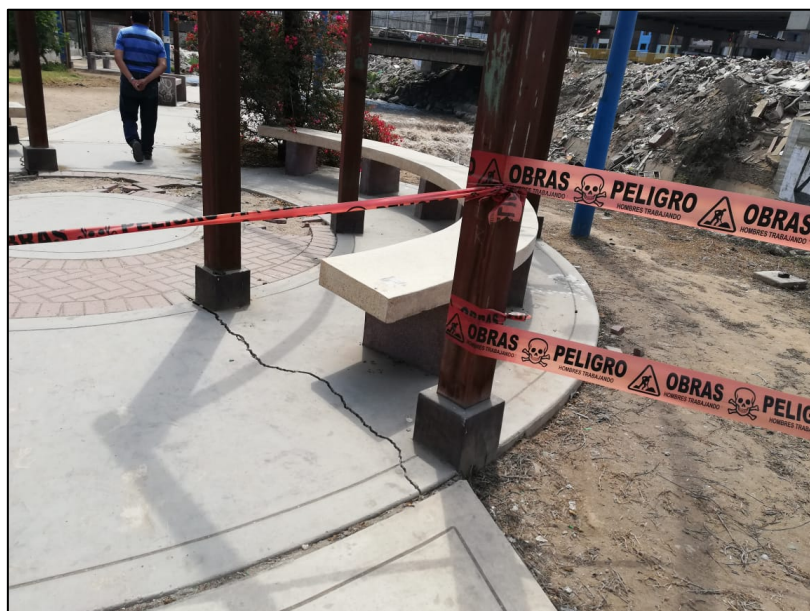
Se observa la presencia de rajaduras en el área de recreación pública del polideportivo cercana a la margen izquierda del río Rímac
