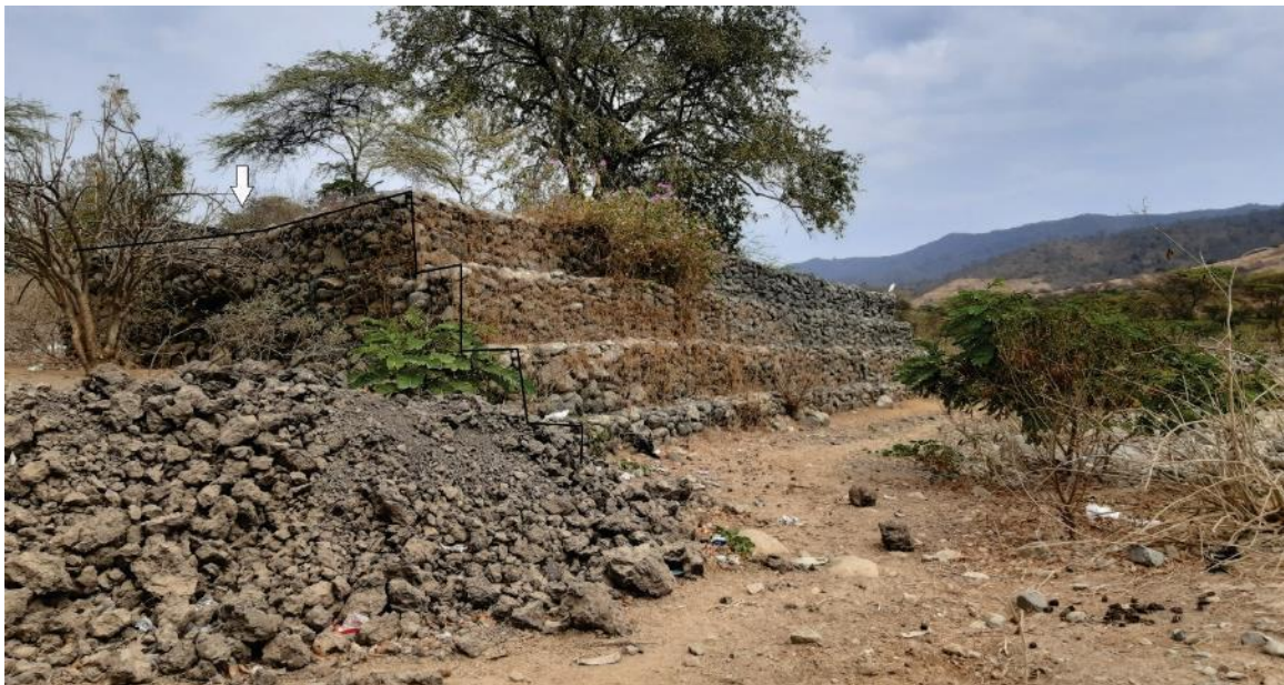
Figura 23. Gavión de mampostería levemente inclinado, afectado por erosión, coordenadas 9497696N y 615986E.
