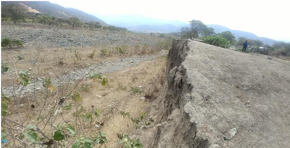
Fotografía 04. Depósitos aluviales 2 en la margen izquierda donde se ubican los caseríos evaluados, coordenadas 9497472N y 615998E.
