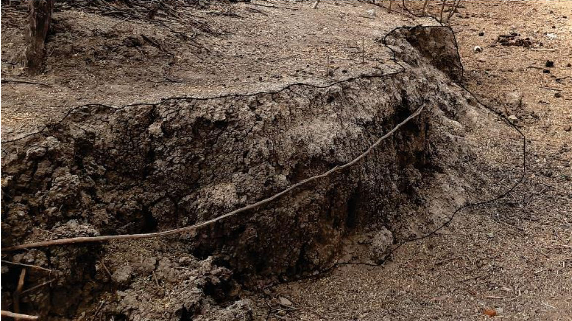
Figura 16. Capas limoarenosas susceptibles a erosión en las coordenadas 9491919N y 634028E.
