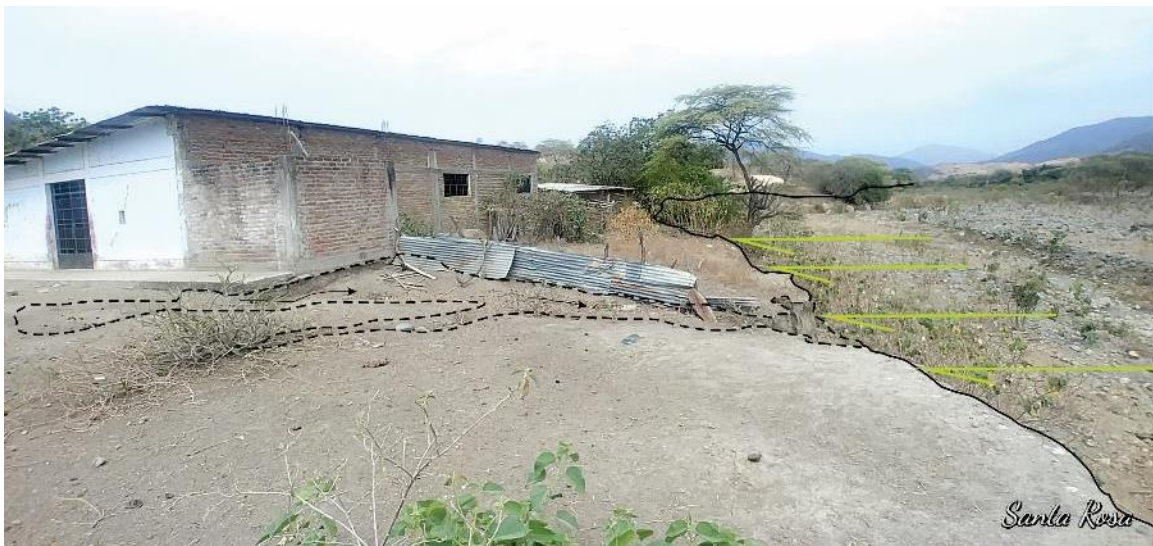
Figura 19. Vivienda y salón comunal Santa Rosa, afectados por cárcavas y erosión fluvial provocada por el ensanchamiento del cauce de la quebrada Suyo, coordenadas 9497861N y 615845E.
