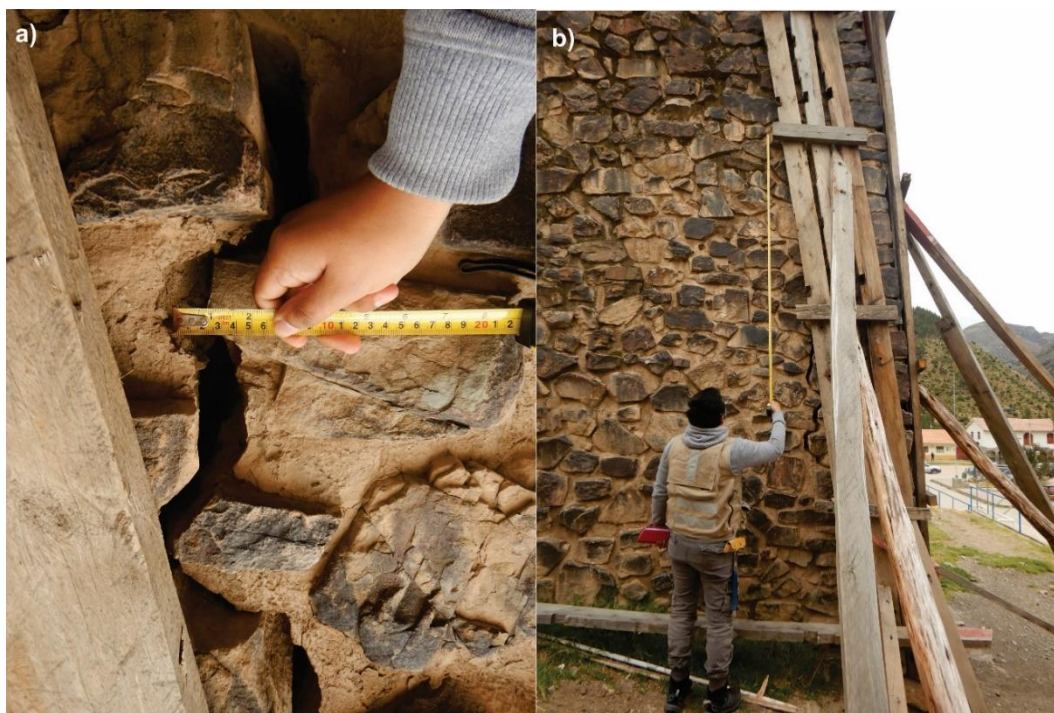
Figura 23. Torre ubicada en la margen derecha de la Iglesia Nuestra Señora de las Mercedes de Pampamarca. a) Se observa agrietamientos en las paredes, de 0.03 a 0.05 cm, b) Agrietamientos transversales de hasta 1.5 y 3.5 m. la construcción se basa en bloques combinadas con arcilla.
