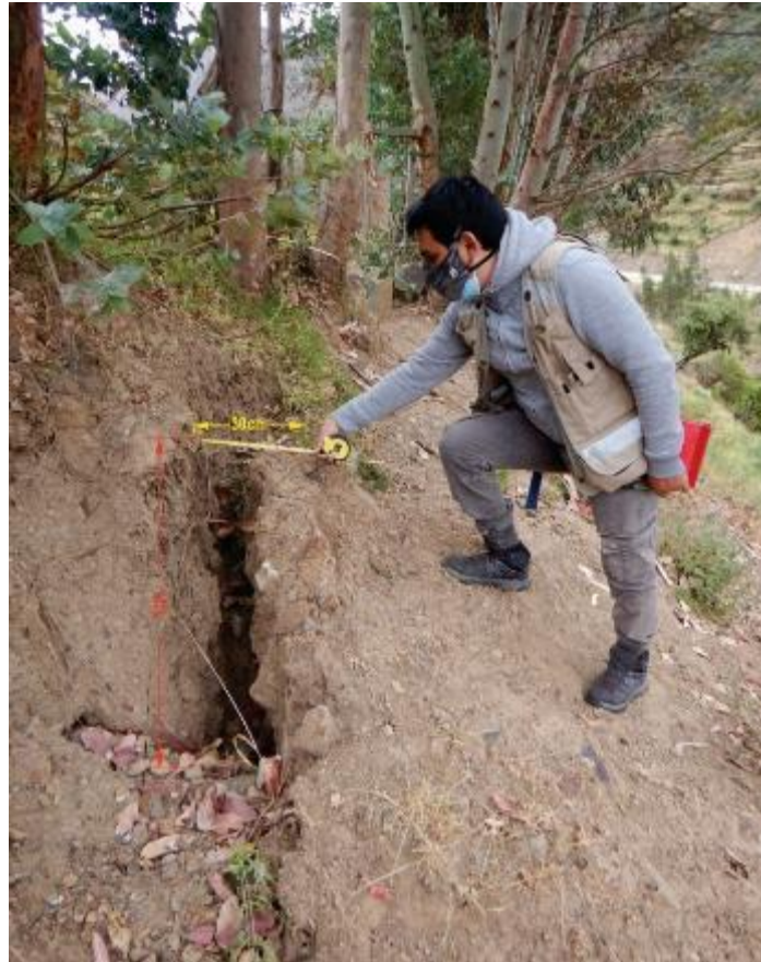
Figura 16. Agrietamiento transversal de 1 m de longitud, profundidad de 1 m, y separación de 30 cm. Ubicado entre las coordenadas UTM 8404512N, 693135E, altitud 3291 m s.n.m.
