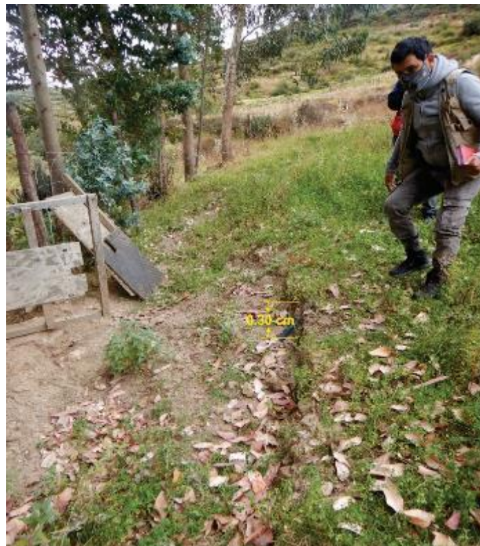
Figura 17. Agrietamiento de dirección NE, con 2 m de longitud y salto de 0.30 cm.
