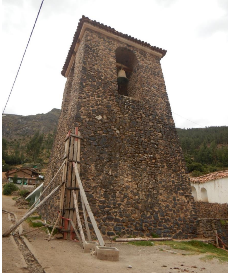
Fotografía 2. Tablones en dos de las caras de la torre, instaladas como medida de seguridad, en febrero de este año. Se encuentra ubicada entre las coordenadas UTM 8404253 N, 693355 E, y una altitud de 3409 m s.n.m.
