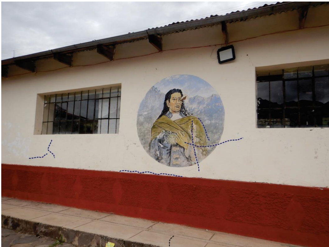
Figura 24. Se observa agrietamientos en las paredes de uno de los bloques, perteneciente a una construcción de hace 50 años.
