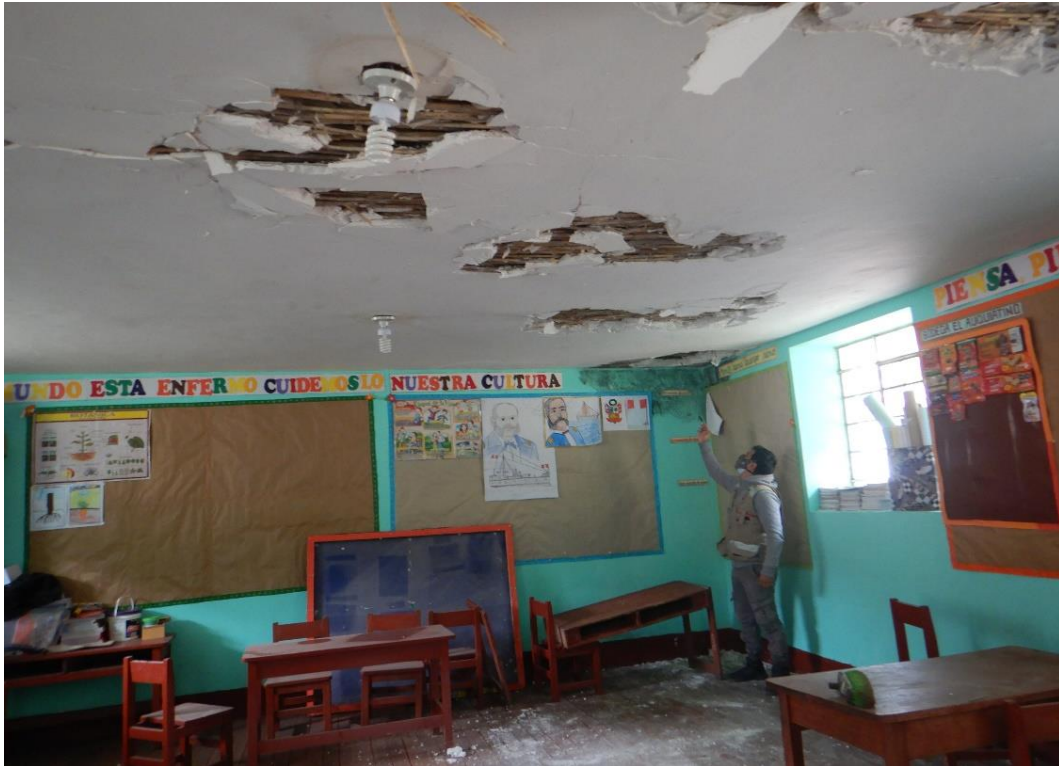
Fotografía 3. Vista de un salón de clase, donde se observa parte del techo colapsado producto de la humedad y del material podrido (carrizos), las mismas que corresponden a la construcción de los años 90.
