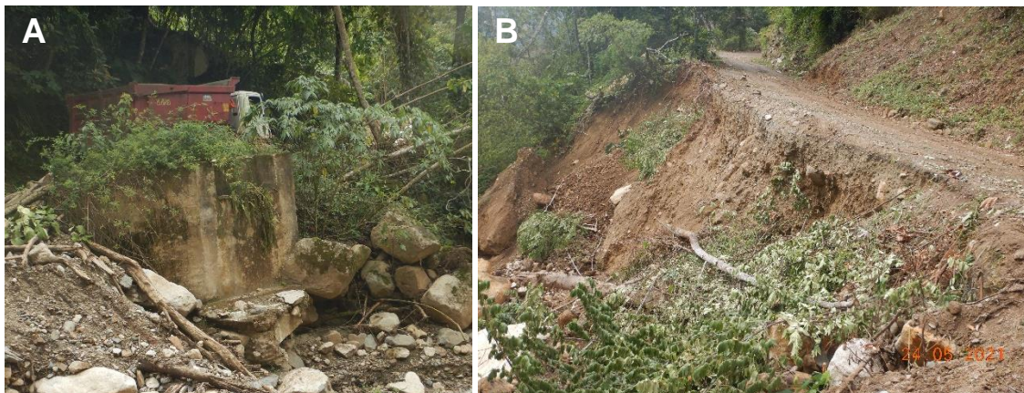
Figura 3. A) Vista del puente peatonal destruido. B) Tramo carretero afectado por derrumbes en la margen derecha de la quebrada San Lorenzo.
