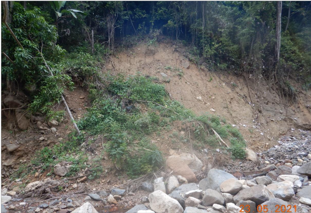
Fotografía 8. Derrumbes reactivados debido a la erosión fluvial que generó el flujo de detritos (huaico). Con coordenadas UTM (WGS 84): 762858 E 8589251 S 981 m s. n. m.
