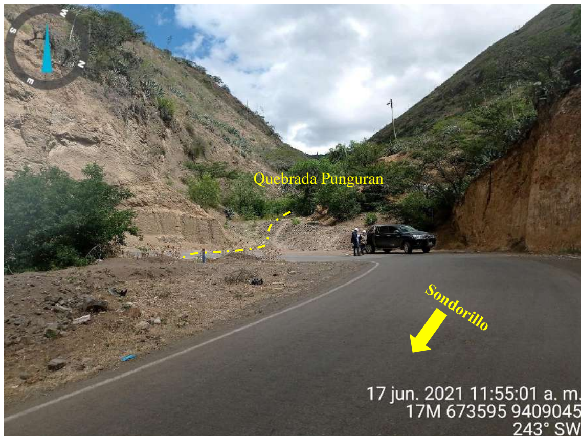
Figura 8: Cauce de la quebrada Pungurán. Los flujos de detritos podría afectar la vía asfaltada Sondorillo – Rumi Corral.
