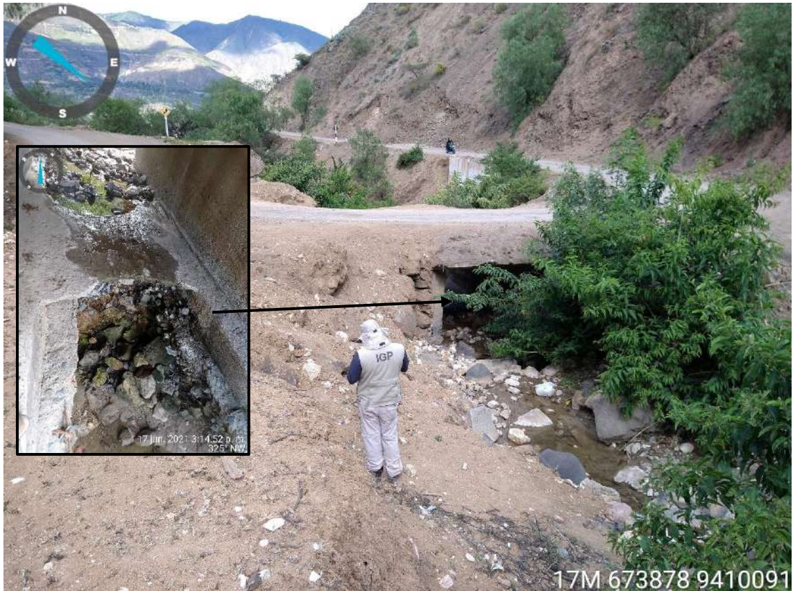
Figura 12: Pontón ubicado en la vía Sondorillo – Huancabamba que ha sido erosionada en el piso de dicha estructura
