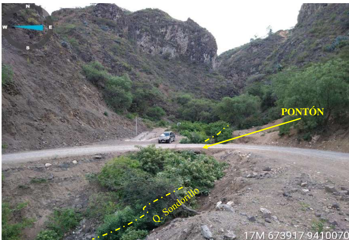
Figura 10: Cauce de la quebrada Sondorillo que fluye oeste a este, durante su recorrido se encuentra erosionando el pontón ubicado debajo de la vía Sondorillo - Huancabamba
