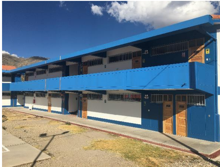
Vista de los pabellones de la I.E. secundaria, en buenas condiciones estructurales.
