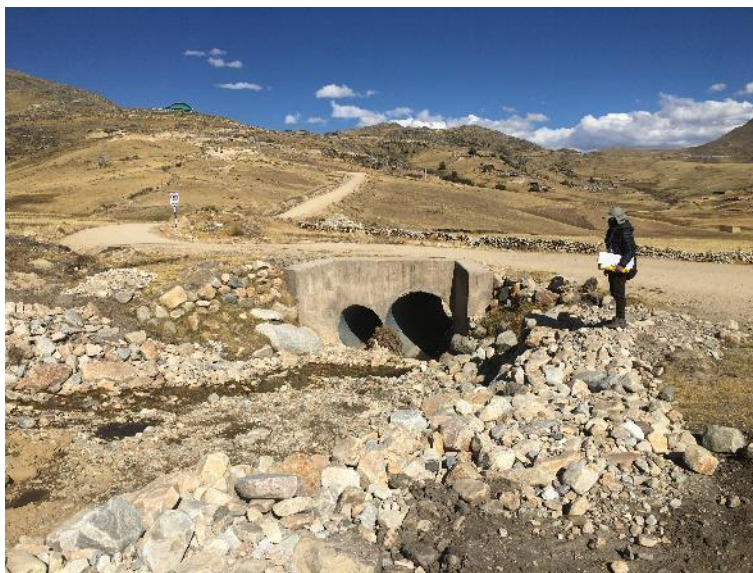
Vista de la alcantarilla que se encuentra mal ubicada y de dimensiones inferiores.
