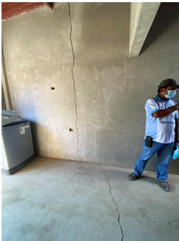
Foto 5. Grietas en muros y suelo con dirección N199 en el anexo Isla San Lorenzo del Distrito de Vichayal.
