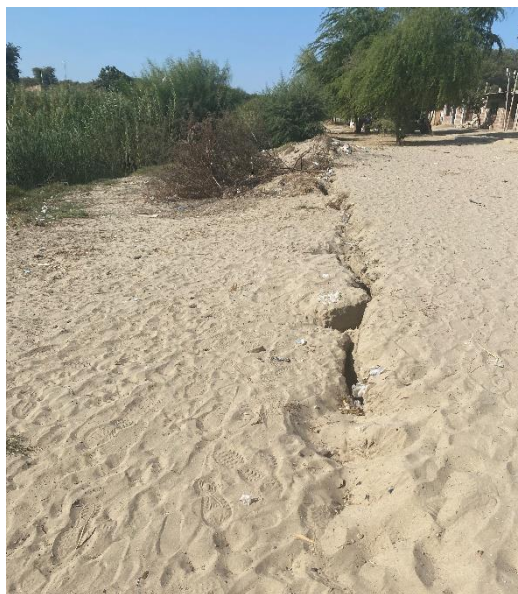
Foto 2. Grieta de ~15 m en el sector denominado El Indio, al sur de la ciudad de Piura.
