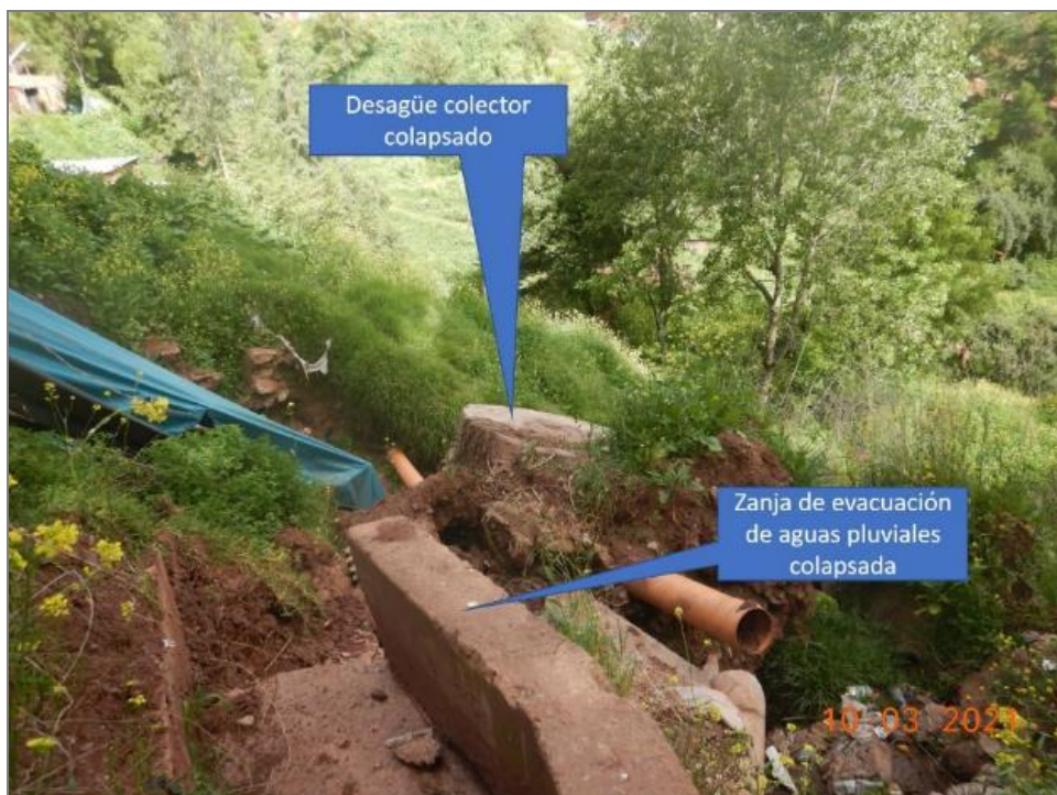
Figura 5. Colapso y daños en zanja de evacuación de agua pluviales y un colector de desagüe.
