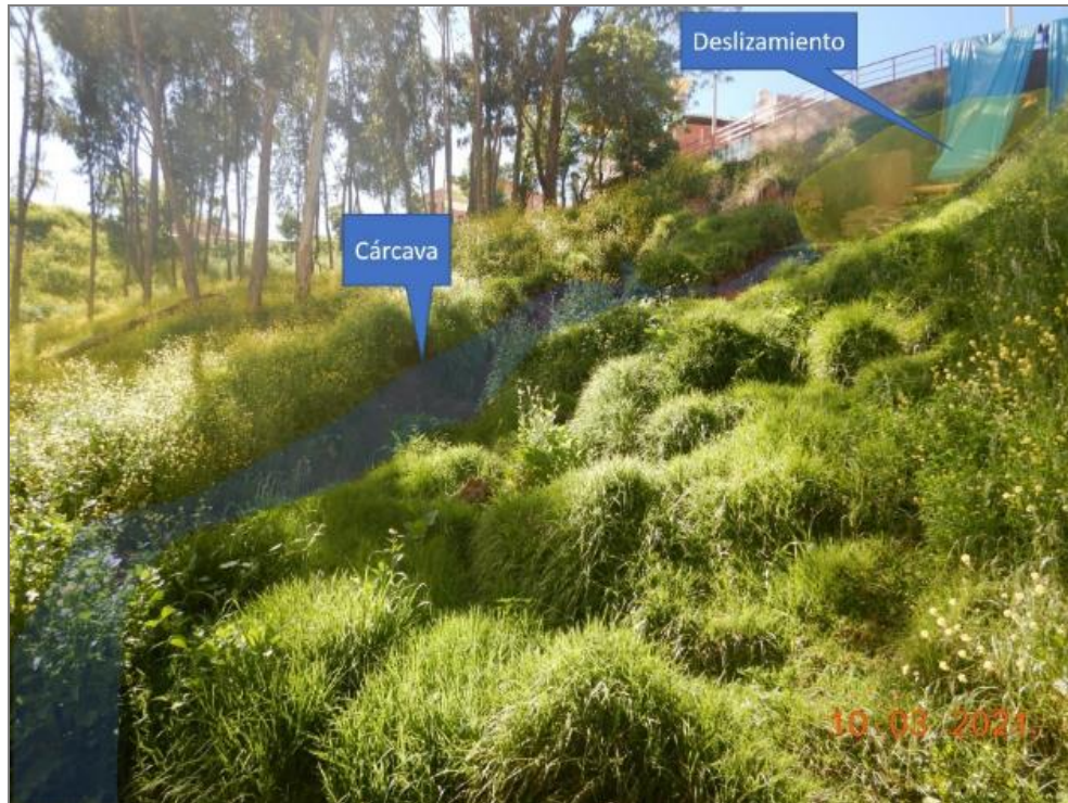
Figura 6. Vista del deslizamiento tomado desde la parte baja de la quebrada Sacramayo, se aprecia el deslizamiento y la cárcava por donde se arrastró el material deslizado.
