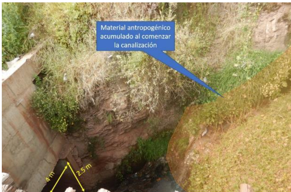
Figura 16. En coordenadas UTM 176396 E, 8502309 N, se aprecia la bocatoma de la canalización de la quebrada de 2.5 m de altura por 4 m de ancho, con materiales obstruyendo la entrada.
