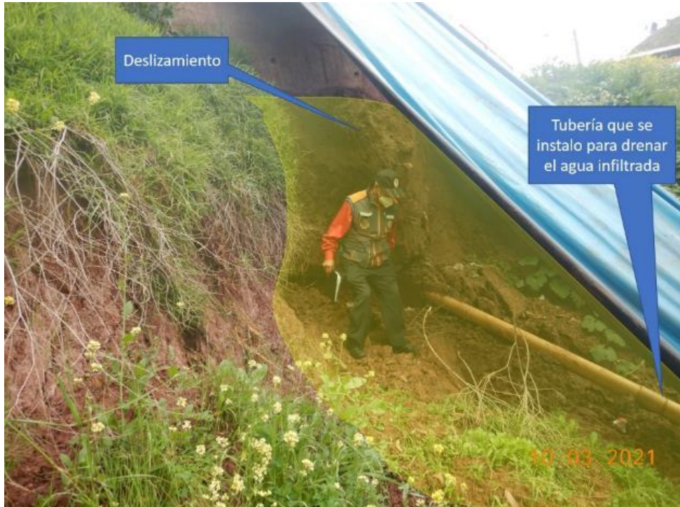
Figura 4. Vista de deslizamiento en la margen derecha de la quebrada Sacramayo (UTM 176030 E, 8502590 N) con presencia de agua infiltrada que discurre por el cuerpo. Se instaló una tubería para captar el agua en la zona.
