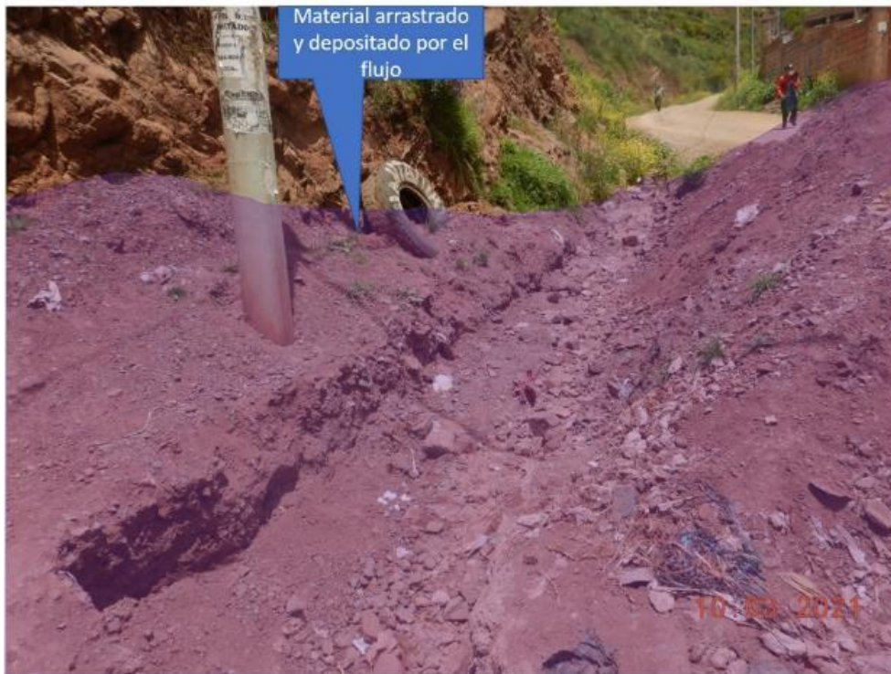
Figura 12. En coordenadas UTM 175870 E, 8501890 N, se aprecia parte de la vía de acceso a la APV San Pedro, que es afectada continuamente por el paso de flujo de detritos con depósitos de los materiales.
