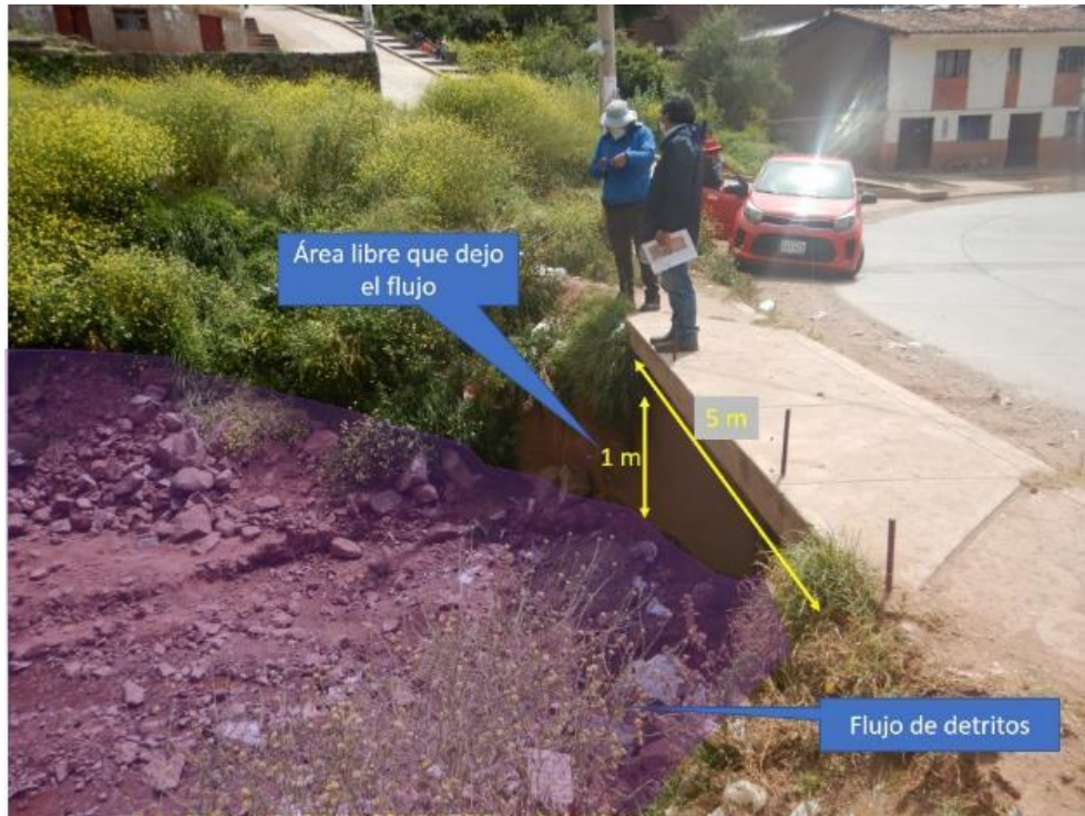
Figura 24. En coordenadas UTM 176756 E, 8500913 N, se aprecia el puente de 4 m de altura por 5 m de luz, que quedó colmatado por el paso del flujo de detritos.
