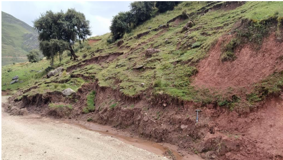
Fotografía 6. Se observa reptación de suelos con escarpes múltiples con un suelo saturado y un canal de agua no impermeabilizado que circula por la cuneta de la carretera el cual desestabiliza el talud. Coordenadas UTM, zona 18s; Datum WGS 84: 370844 E, 8829412 S
