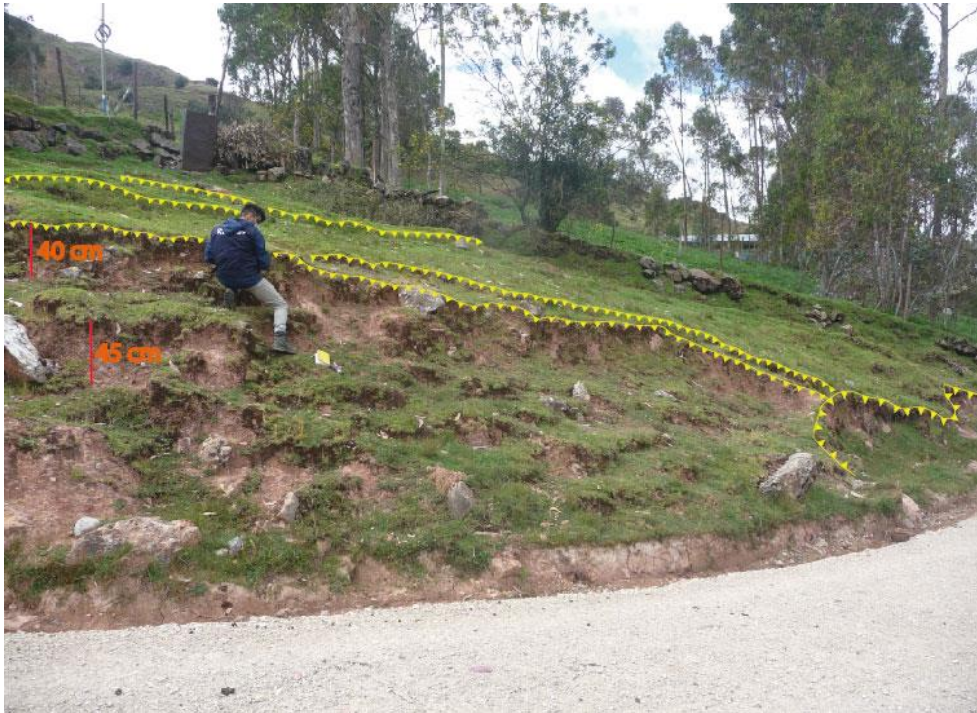
Figura 11. Se observa reptación con escarpe enmarcados en líneas amarillas con saltos de hasta 45 cm. Coordenadas UTM, zona 18s; Datum WGS 84: 370538 E, 8829135 S.
