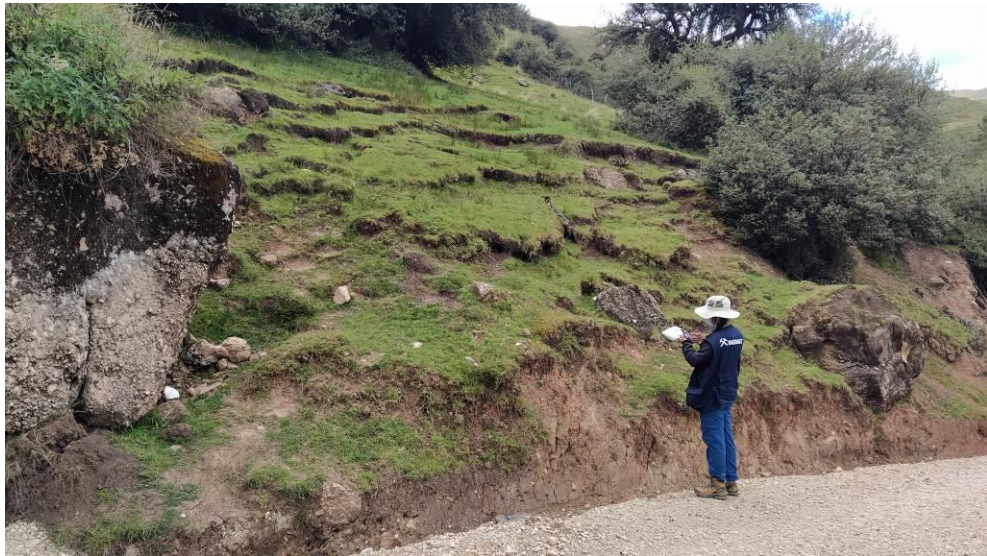
Fotografía 7. Se observa reptación con saltos de escarpes que van desde 20 a 35 cm y árboles inclinados. Coordenadas UTM, zona 18s; Datum WGS 84: 370541 E, 8829476 S.
