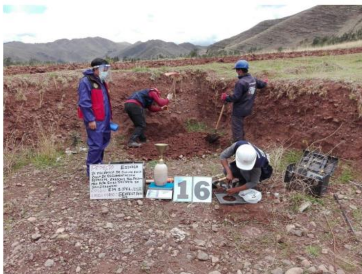
Fotografía: Apertura de calicatas y supervisión por parte del Equipo Técnico del componente GRD.
