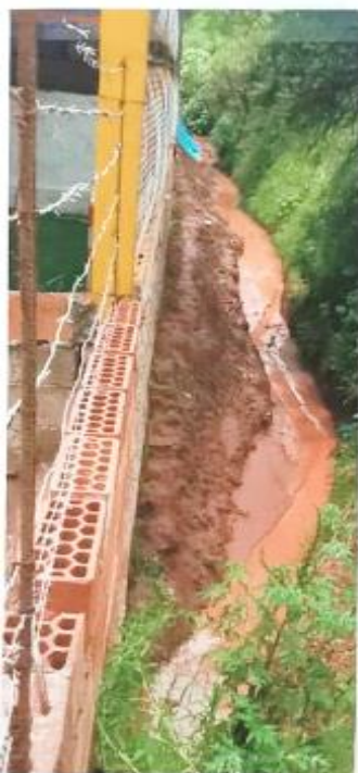
Fotografía 25: Flujo de lodos en cancha sintética de la A.P.V. Manhuañoncca Primera etapa
