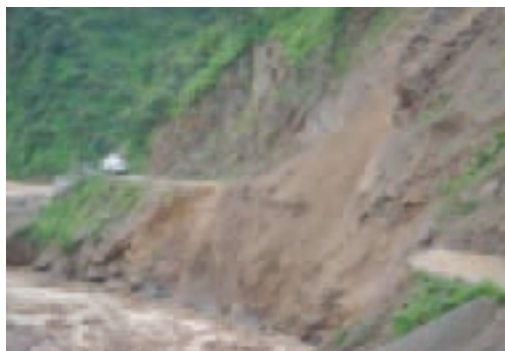
Corte de carretera por avalancha o «huaico».
