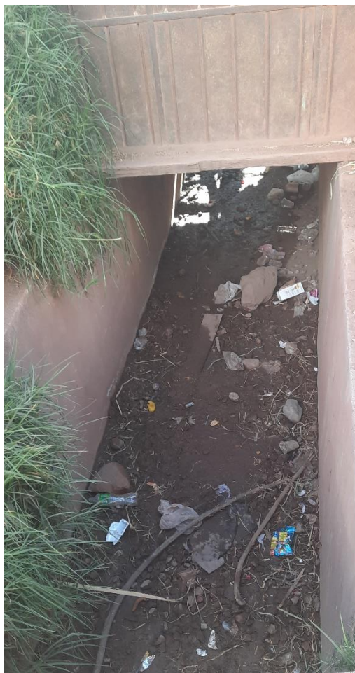
Fotografía 3: Acumulación de residuos sólidos en zona del canal de evacuación de aguas pluviales Fuente: Equipo Técnico PM41ZRE
