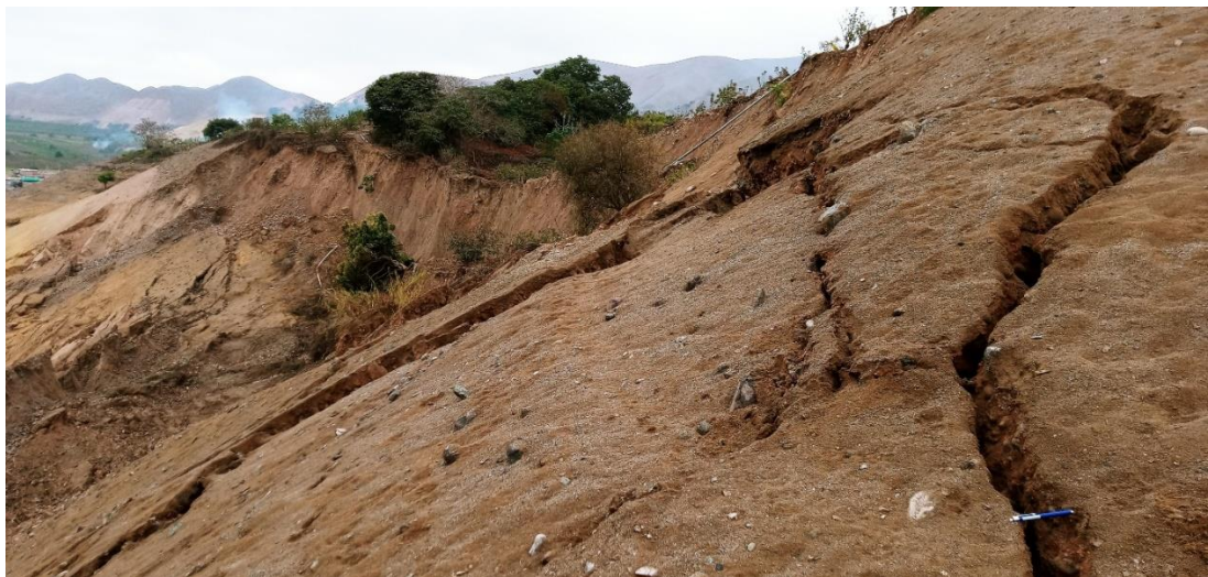
Fotografía 11. Se observa el ancho de las grietas ubicadas en el lado izquierdo del Deslizamiento El Arenal.
