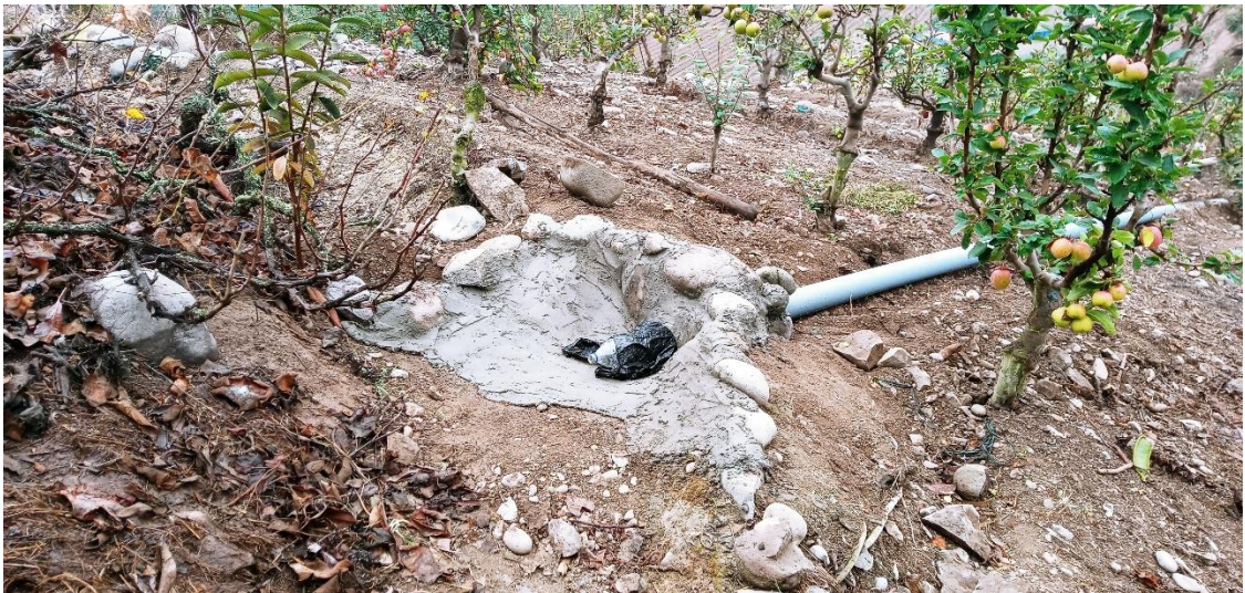
Fotografía 12. Sistema de riego inadecuado para cultivo de manzanas ubicado en la cabecera del deslizamiento.
