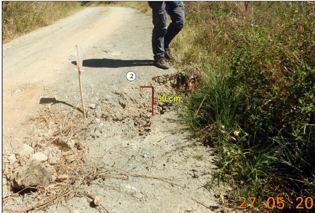
Figura 4. Vista del desplazamiento en el camino carrozable que conduce a pueblos aledaños.
