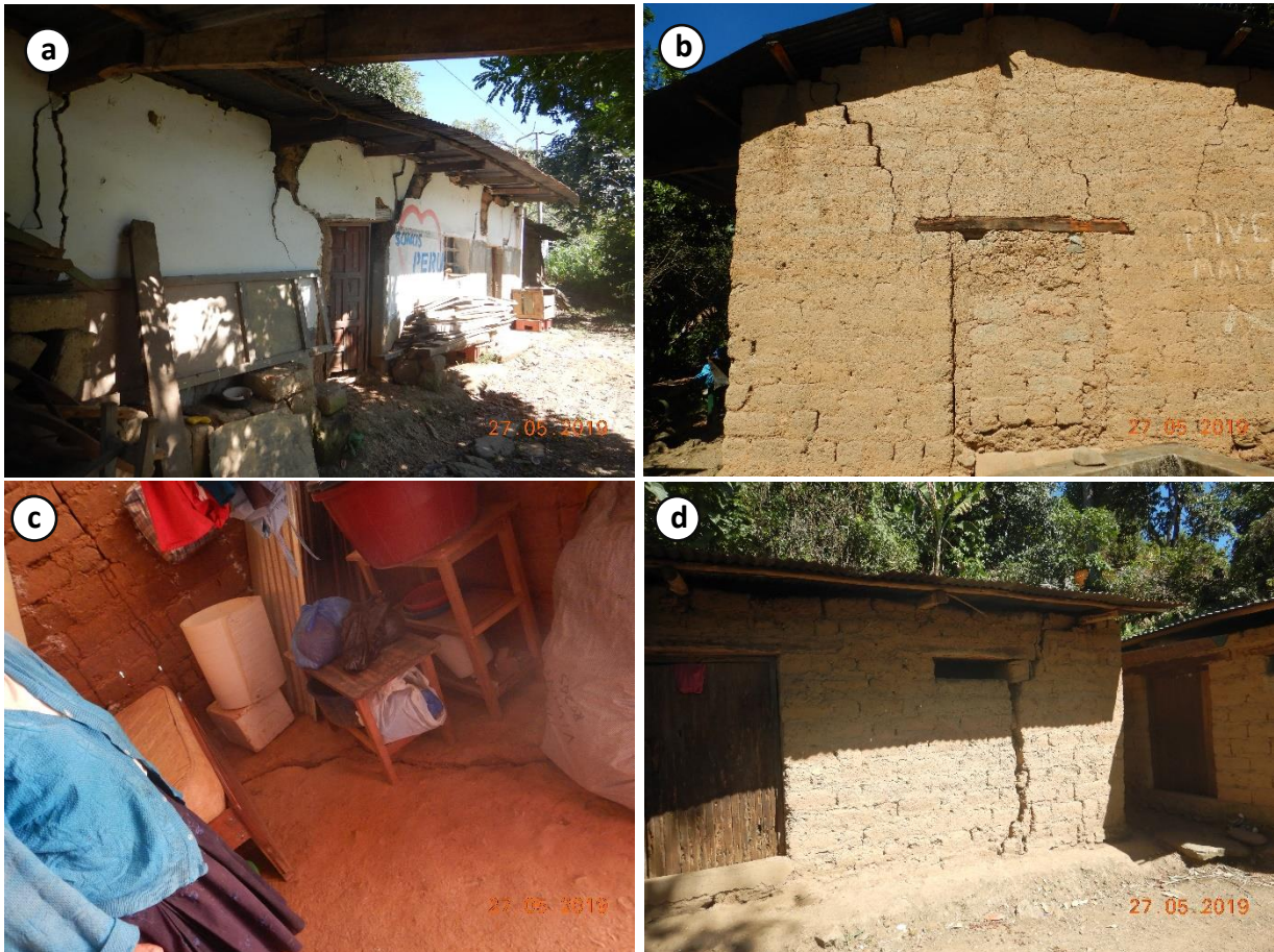
Figura 5. a, b) Vista de viviendas agrietadas en dirección N 76°. c) Vivienda con pared y suelo agrietado en dirección N 155°, el piso tiene una abertura de 5 cm. d) Vivienda agrietada en dirección N 275°.
