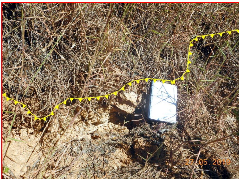
Figura 2. Vista del deslizamiento, con desplazamientos que varían de 0.3 a 0.5 m.
