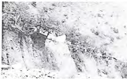
Erosion de la Margen derecha del Rio Huertas en la localidad de Uchucyacu.
