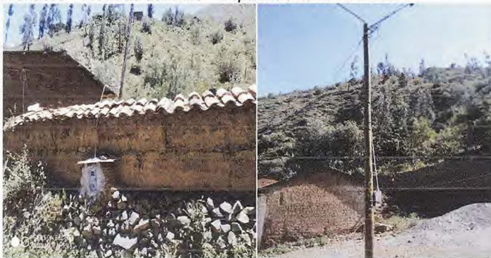
Figura 3: Electrificación en la Localidad de Uchucyacu, del distrito de San Francisco – Provincia de Ambo – Departamento de Huánuco.
