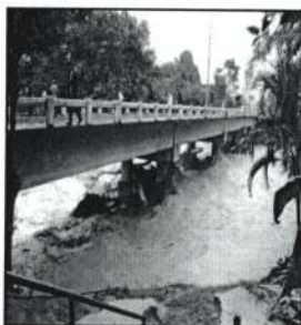
AFECCIÓN DEL PUENTE CUMBAZA
