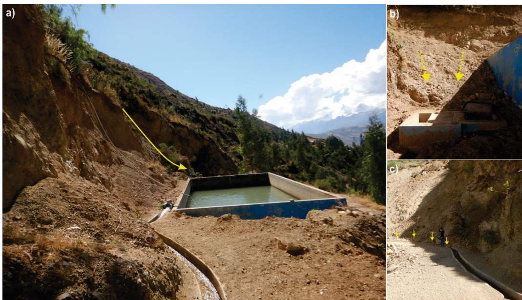
Figura 12. a) Reservorio y tubería afectados con el material desplazado; b) Alcantarilla cubierta por el material del deslizamiento; c) Canal de riego de concreto afectado, se realizó la limpieza, posterior a la ocurrencia de deslizamiento, actualmente en uso.
