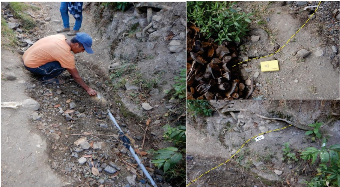
Figura 15. Vista donde se observa una tubería de agua potable, la misma que fue repuesta en dos oportunidades, producto de la presencia de agrietamientos.
