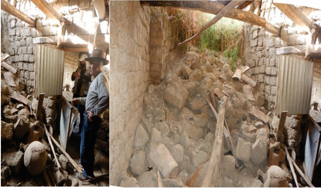
Figura 18. Fotografías que muestran el colapso de parte de una vivienda, la cual inició con la presencia de agrietamientos.
