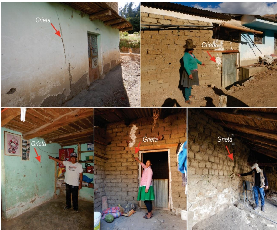
Figura 17. En las imágenes es posible observar los agrietamientos en las paredes de adobe de algunas viviendas de un sector del centro poblado de Rampac Chico.
