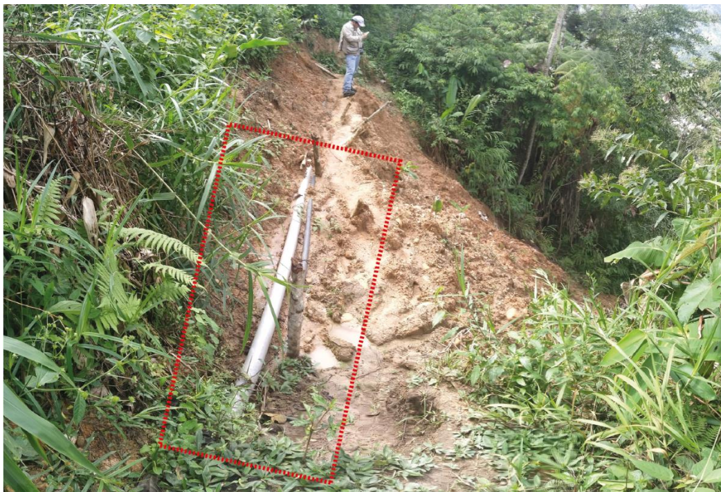
Figura 30. Tuberías que aportaron a la escorrentía superficial, por ruptura.
