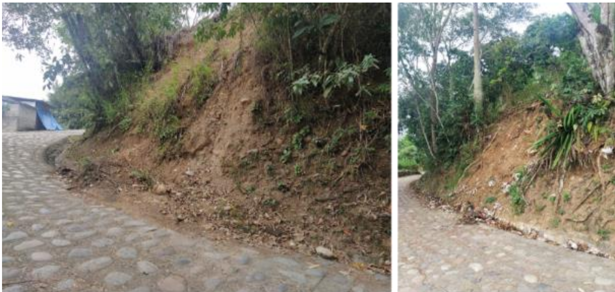
Figura 17. Se observan derrumbes en la ladera del Cerro La Cruz, que obstruyen drenes de escorrentía superficial
