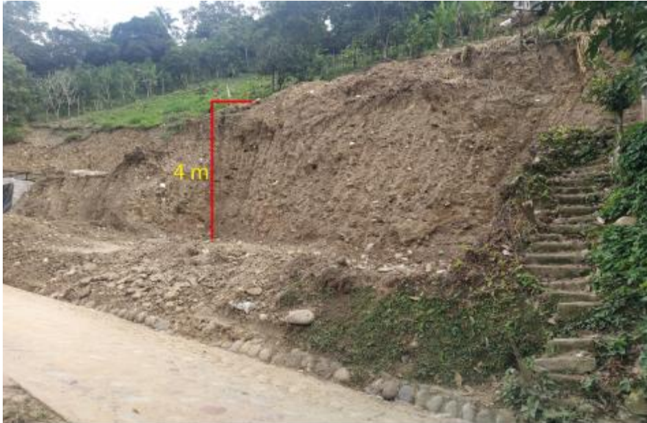
Figura 18. Excavación de la ladera del Cerro La Cruz, lo que favorece su inestabilidad
