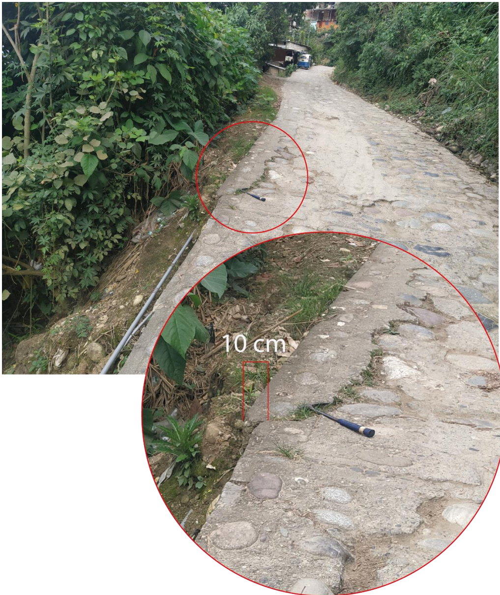
Figura 20. Agrietamientos y desplazamientos horizontales a favor de la pendiente en la ladera del Cerro La Cruz.
