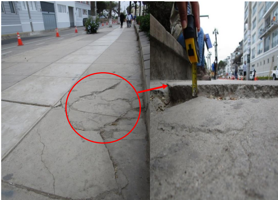
Figura 41. Imágenes de las grietas y asentamientos observados en el Malecón Souza, en el distrito de Barranco.
