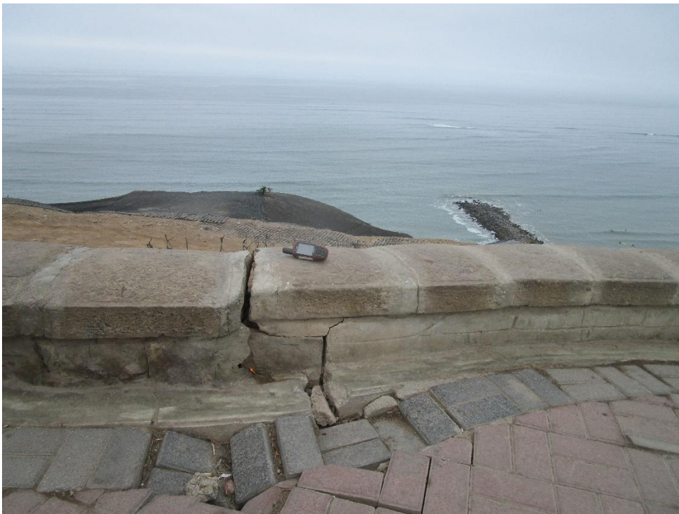
Figura 4. b) Asentamientos del suelo y grietas en los ACV, a la altura del Malecón Souza, en el distrito de Barranco,
